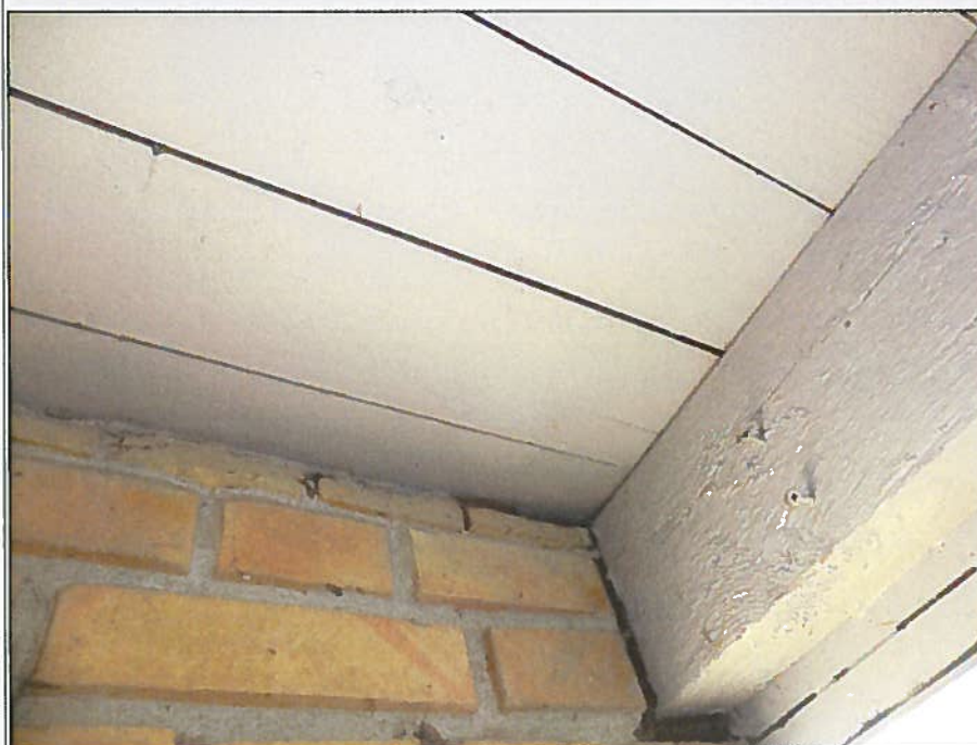
Foto 1 februar 2012 Foto 2 oktober 2012. Foto 3 november 2012 fuge placering . Foto 4 loft set ved hjørne under fuge.
