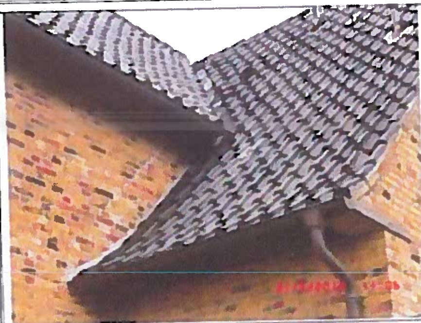
11. Nedslidt skotrende. (sydøst)
