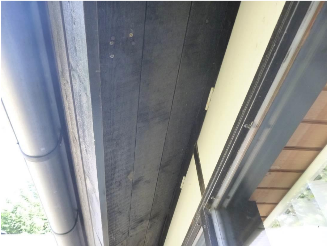
Foto 7 Stern og underbeklædning er formodentlig skiftet i forbindelse med et nyt tag – der er kun meget begrænsede luftspalter.
