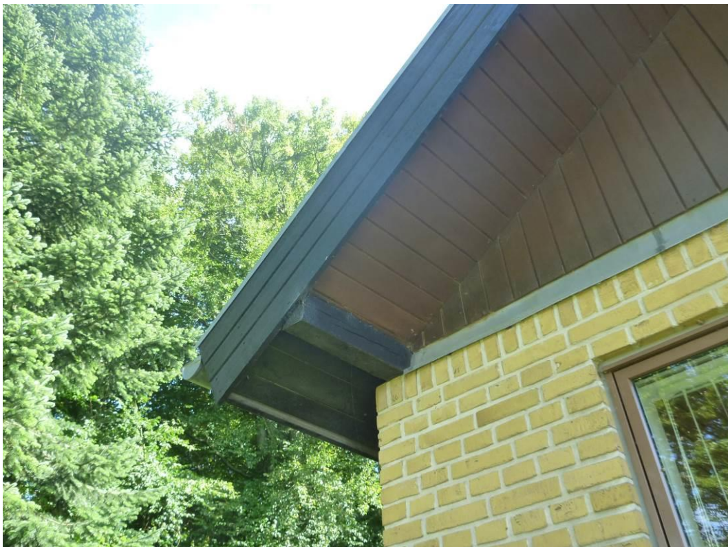
Foto 8 Langs gavlene er der en anden underbeklædning, som formodentlig er den oprindelige – denne er også uden luftspalter.
