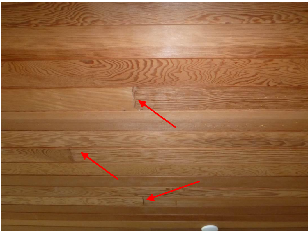
Foto 10 Enkelte gabende samlinger i et ellers fint og intakt profilbræddeloft.
