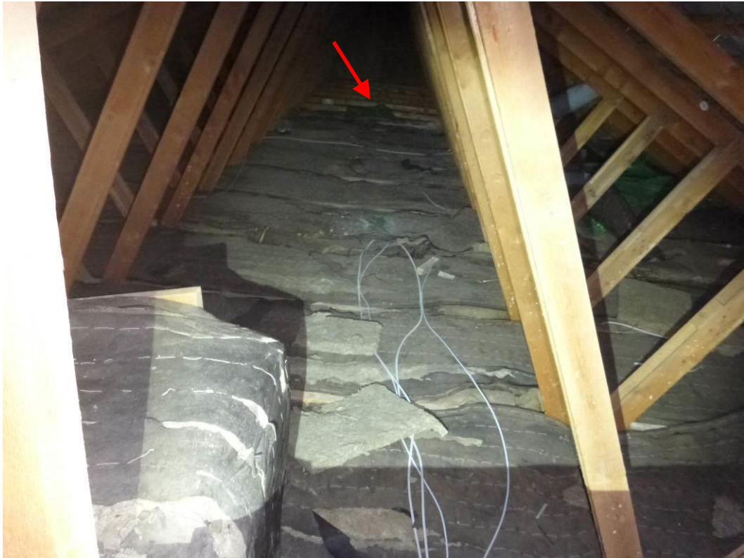
Foto 3 Tagrummet er svært at besigtige, som følge af en manglende gangbro. Bagest i billedet kan man fornemme det nedhængte loft over opholdsstuen.
