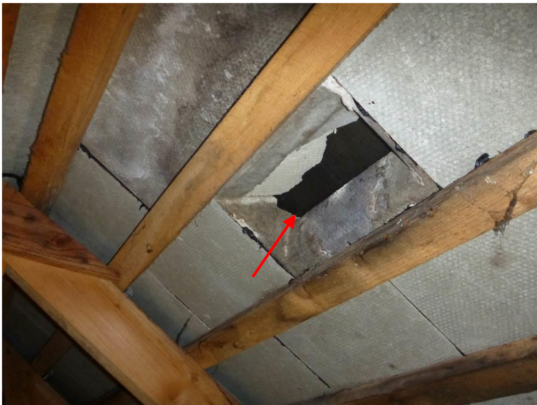
Foto 5 Ved en tidligere taghætte kan man se den nye tagbelægning – hættens vil i nogen grad medvirke til lidt ventilation af tagrummet (og der er muligvis flere).
