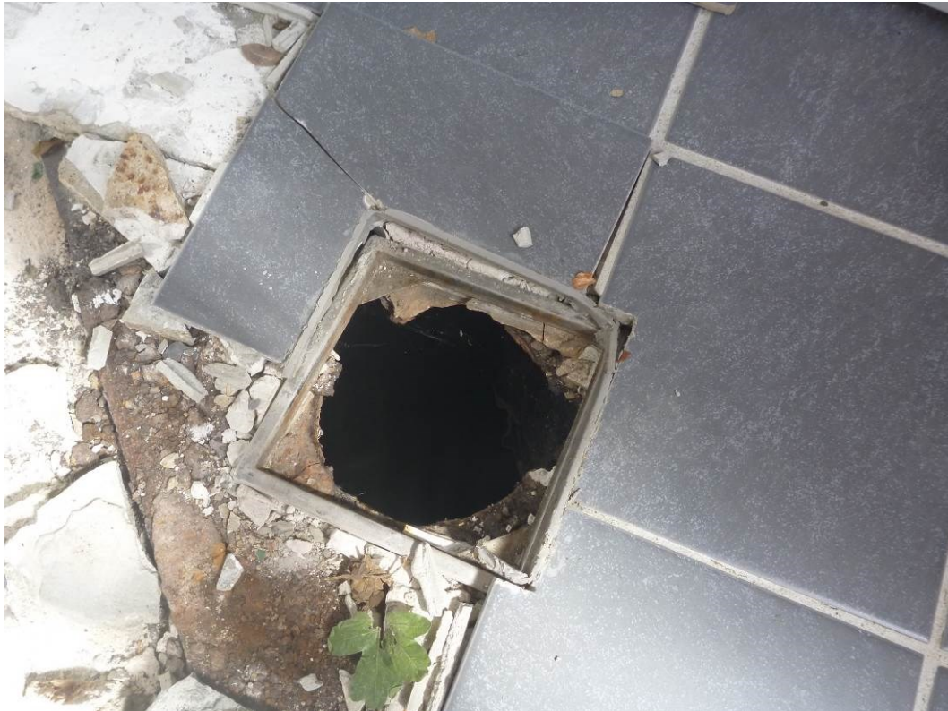
Foto 3 Når risten på gulvafløbet fjernes, ses der en stålplade i kanten, som er kraftig angrebet af rust.
