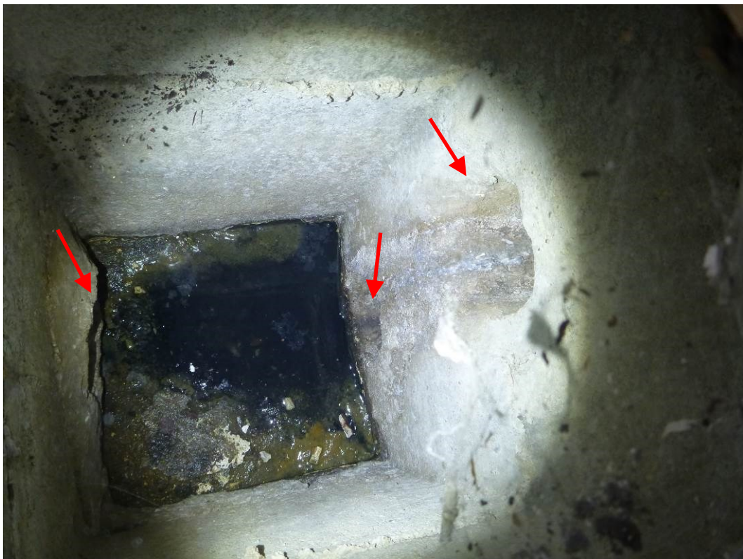
Foto 4 Betonbrønden under afløbsrammen med 2 tilløb i højre side, og et udløb nederst til venstre – bemærk at der er vand i bunden.
