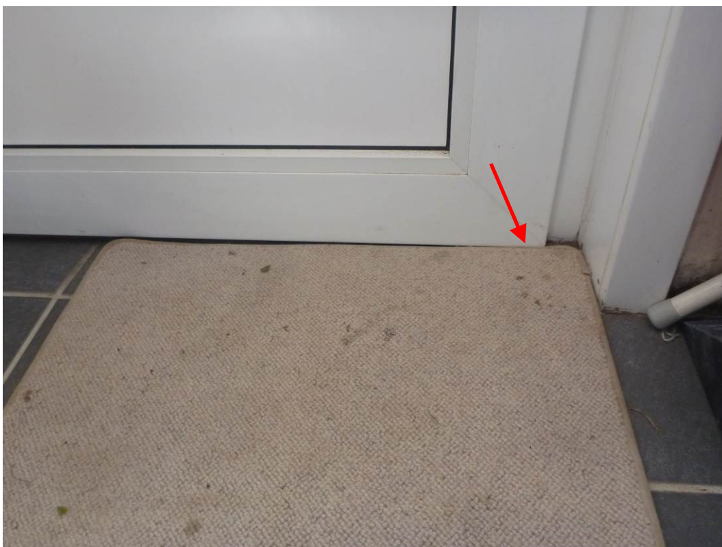
Foto 6 Nedlægges der et stykke tæppe foran yderdøren, kan den ikke åbne.
