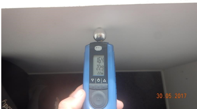
Fugtmåling ca. 90 cm oppe på pladebeklædning i kælderværelse.
