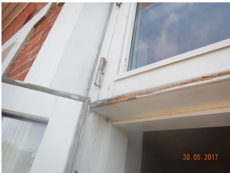
Mørhed i "drypnæse" på de to køkkenvinduer.
