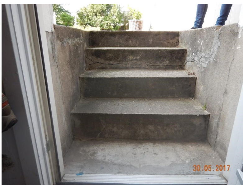
Kælderskakt mod haveside med skader i betontrappe og sidevanger. Der forekommer ingen afløb fra bunden af kælderskakten.
