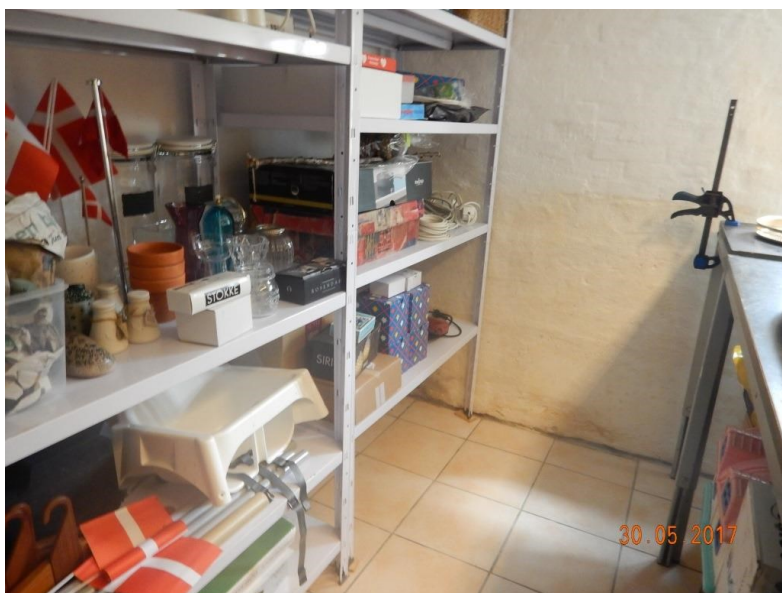
Kælderydermur i nordøstligste hjørne med fugt og mindre afskalninger.
