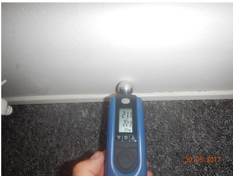
Fugtmåling nederst i pladebeklædning i kælderværelse.
