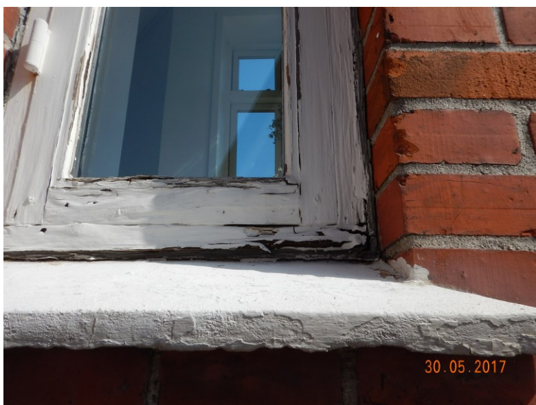
Nedbrudt træ i karnapvindue.
