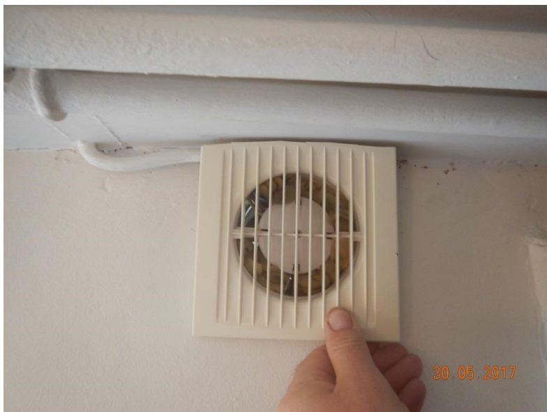
Ventilationskanal i badeværelse i kælder, som er tilstoppet med skumgummi.
