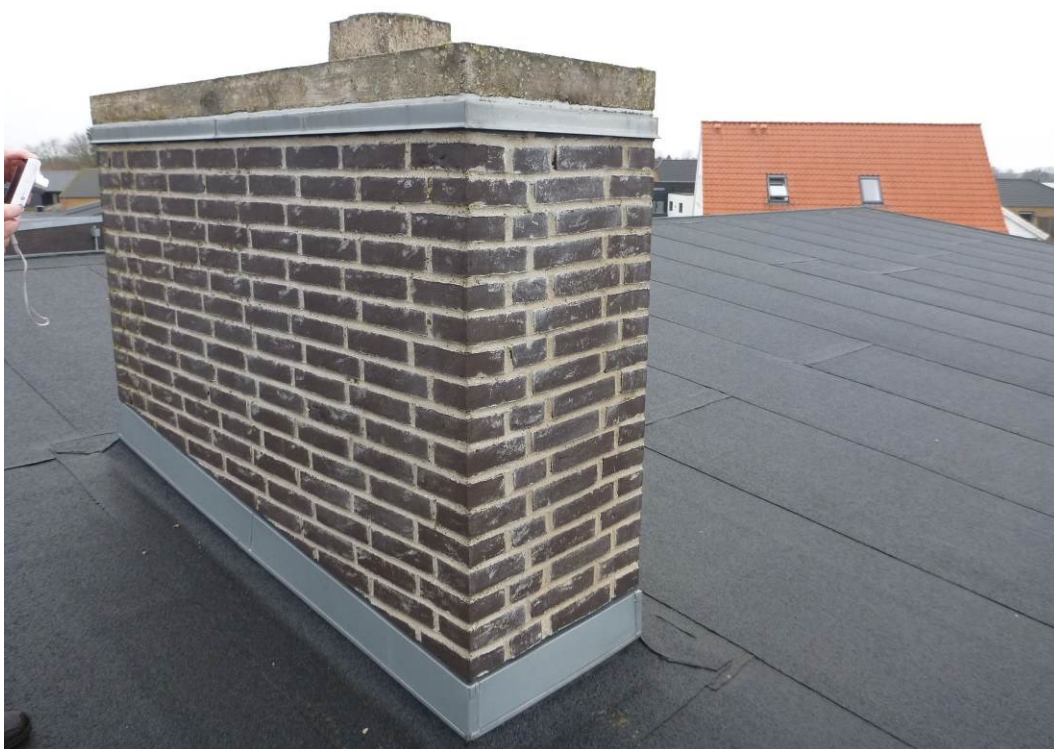
Foto 11 Den murede skorsten over tag, hvor murværket ses med lidt "mørtelrester" som kunne tyde på at der er foretaget en omfugning af denne.
