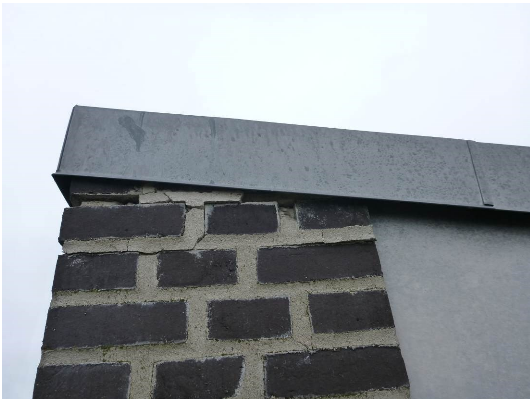
Foto 6 Løse og revnede murværksfuger mod sydøst, øverst ved den murede søjle. Billedet er taget fra opstillet stige.
