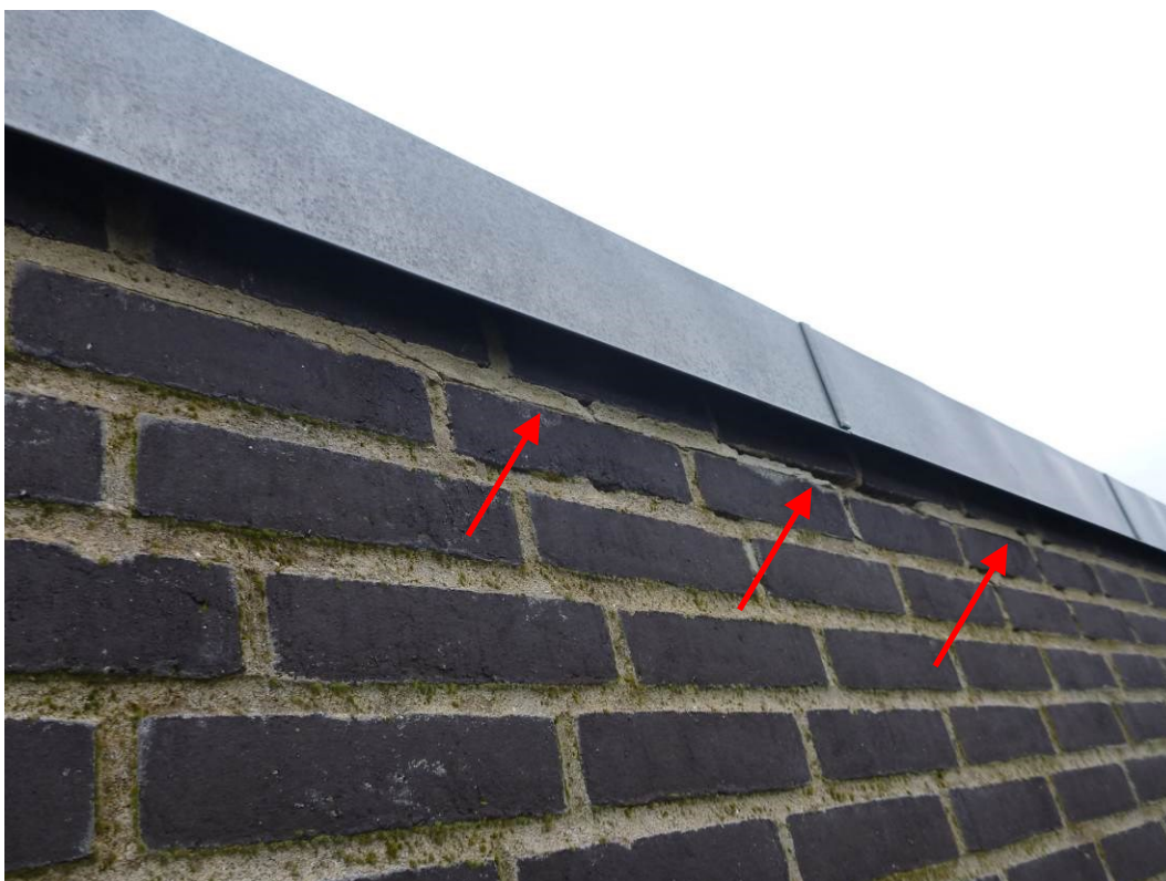
Foto 5 Løse og revnede murværksfuger mod syd, øverst under murkroneinddækning.
