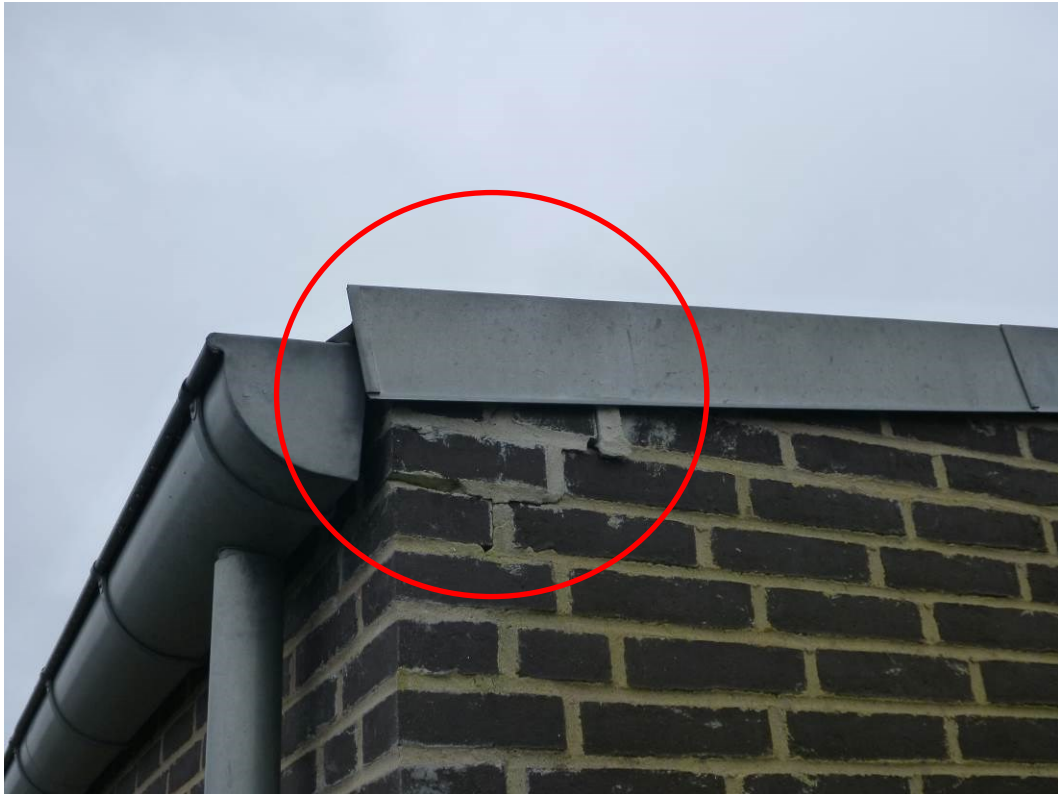
Foto 7 Ved de udvendige hjørner, her øverst mod nordvest, er der både løse fuger og løse mursten. Der er tegn på at murværket har været omfuget.
