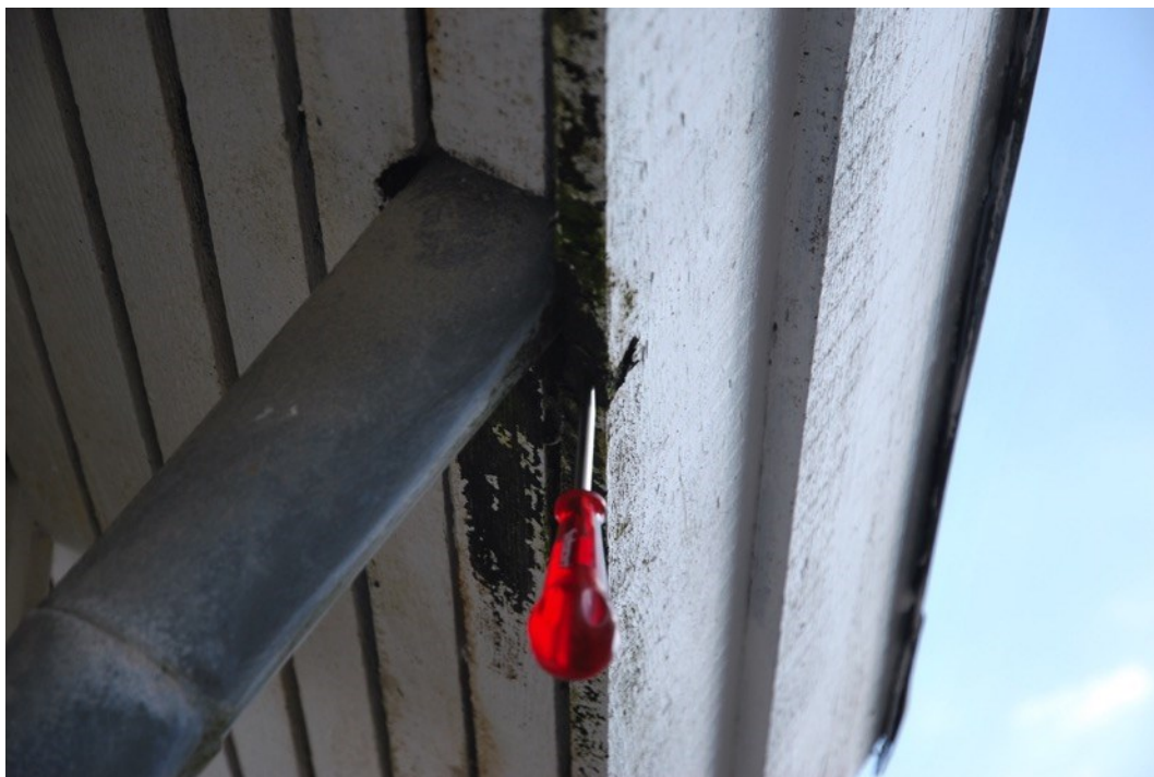
Foto nr. 3 Nedbrudt træ i udhæng ved hushjørne mod sydvest
