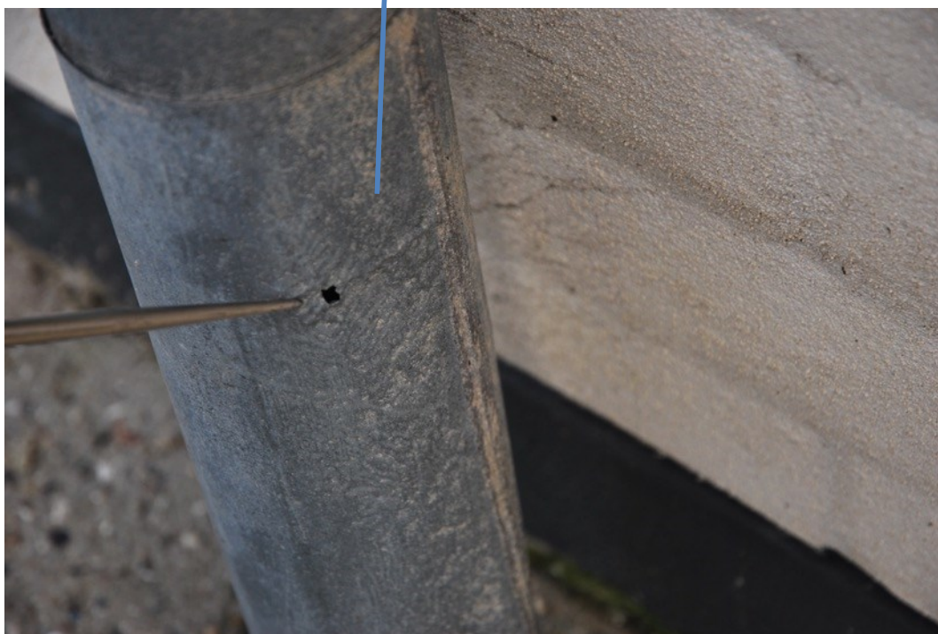
Foto nr. 6 Utætheder i tagnedløb mod sydvest. Tæret pga. alder.
