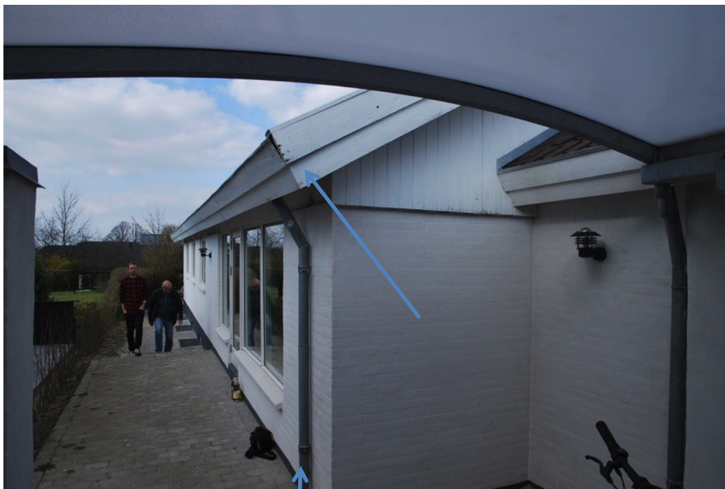
Foto nr. 5 Skaden er umiddelbart synlig når man går rundt om huset
