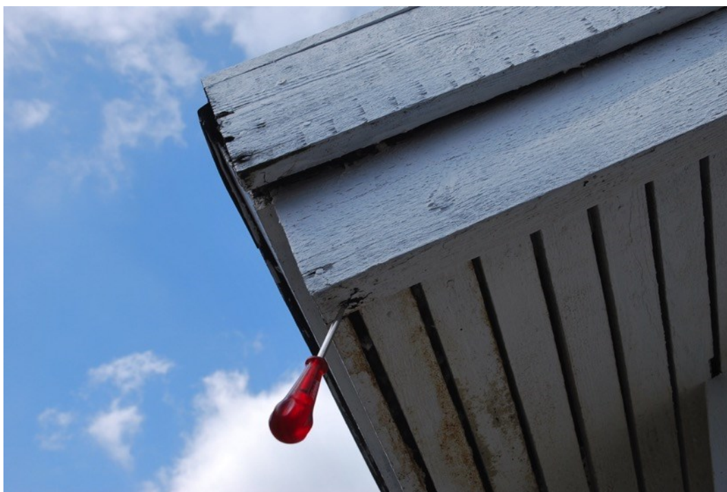
Foto nr. 4 Nedbrudt træ i stern og vindskede ved hushjørne mod sydvest
