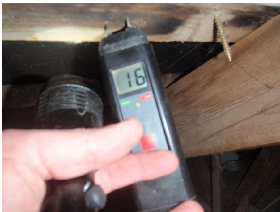
Foto 8 visende p.t. tørre ved fugtmåling
