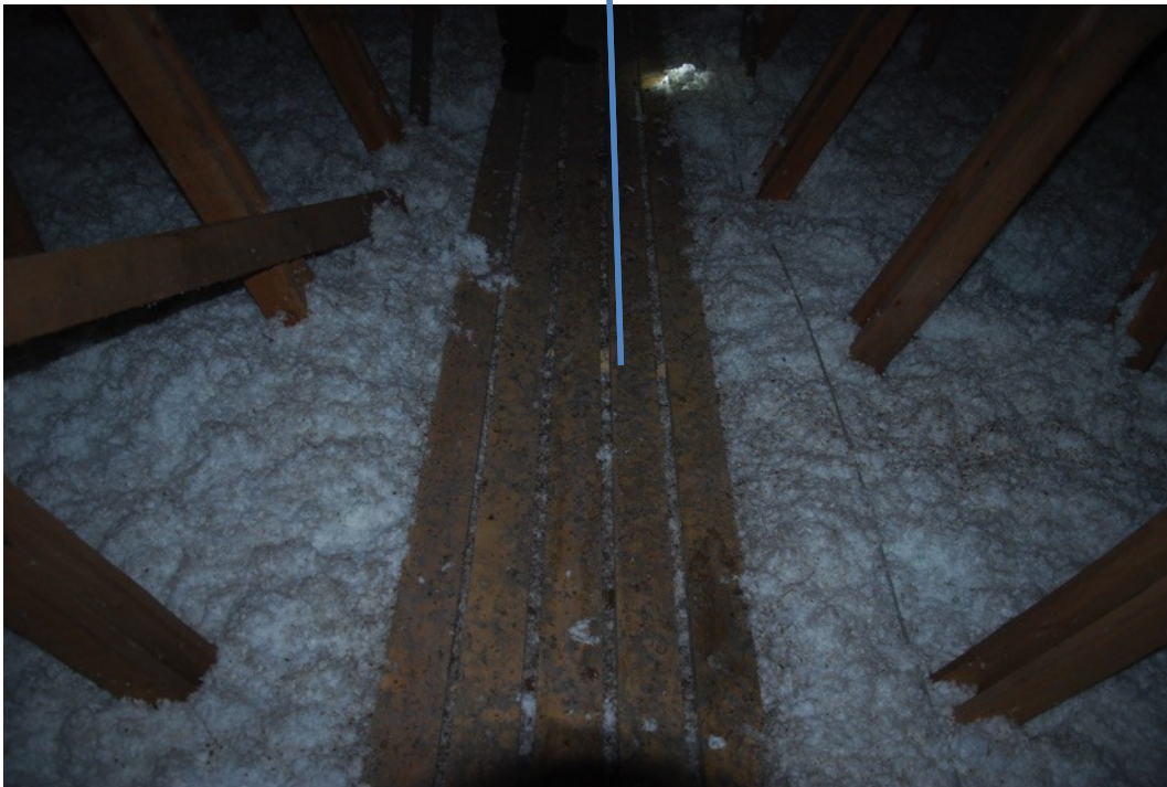
Foto nr. 4 Skidt på gangbro i den fjerneste ende af tagrummet, mod nord, længst væk fra lemmen
