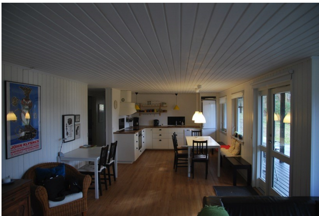
Foto nr. 6 Sommerhus. Loftet mod tagrummet er tæt og adgangsløkken er placeret udvendigt
