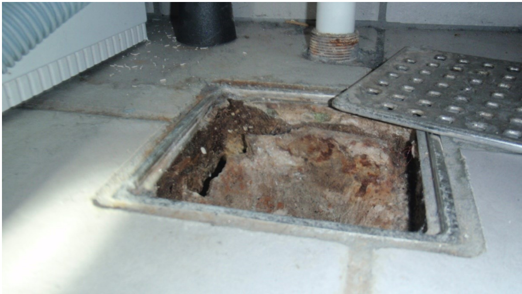
Foto 9 visende hul i gulvafløb
