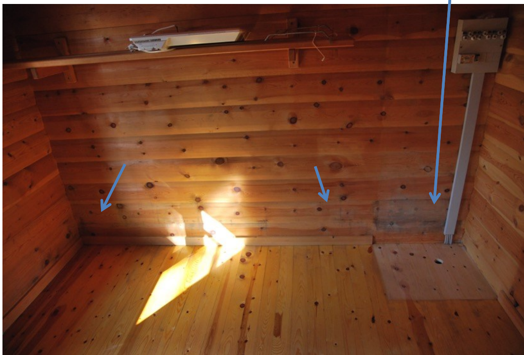
Foto nr. 4 Soveværelse, gavlvæg mod nord. Ved huseftersynet har der været opstillet en seng langs væggen
