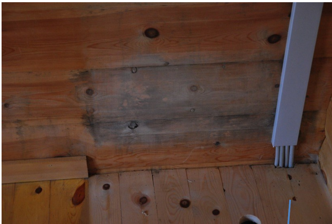
Foto nr. 3 Soveværelse, hjørne mod entré. Ved huseftersynet har der her været opstillet et fast skab, uden bagbeklædning. Skabet har, jf. KL, været fyldt med havehynder
