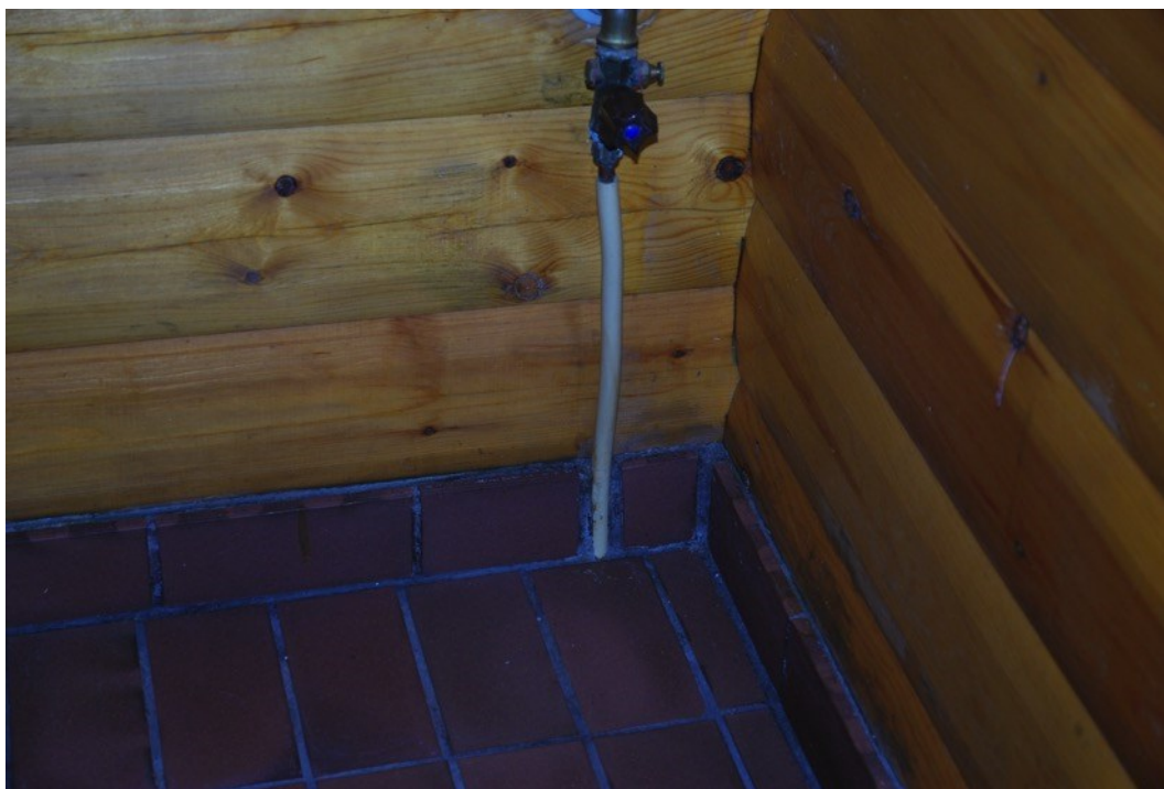
Foto nr. 6 Bad, her i brusenichen op ad nordgavlen Misfarvninger og lidt blåsplint på de nederste blokhusrædder samt på bagvæggen
