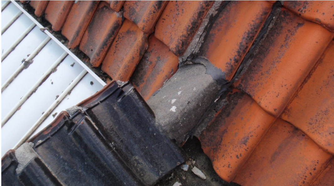
Foto 5 visende efterreparation, revner, slip ved betonpuder mod tagsten og brandmur
