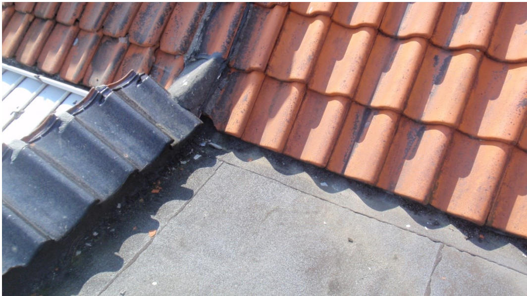
Foto 3 visende betonpude ved brandmur
