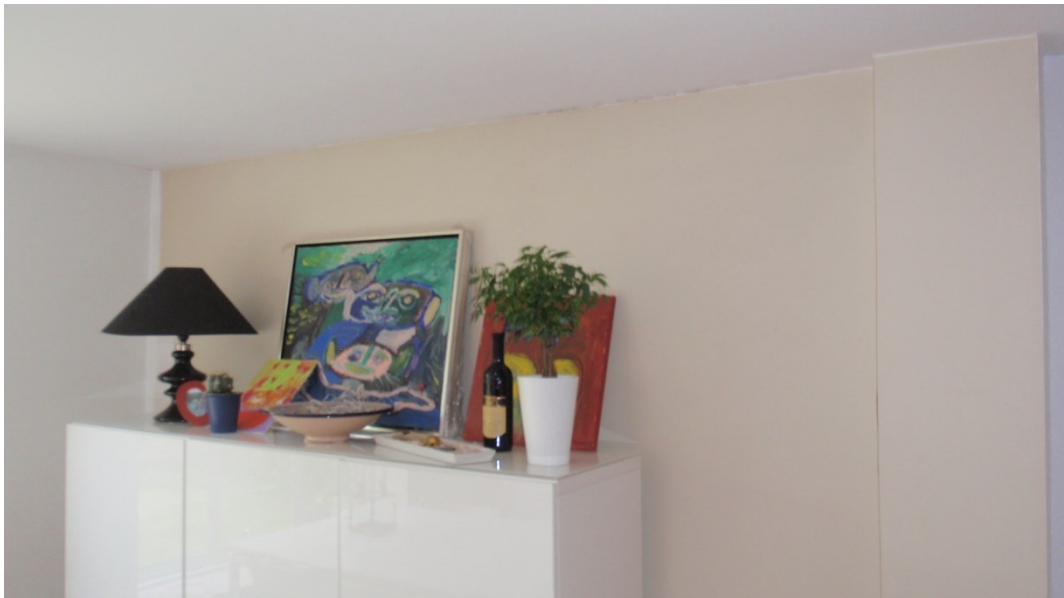
Foto 9 Fugt i stue/massiv mur
