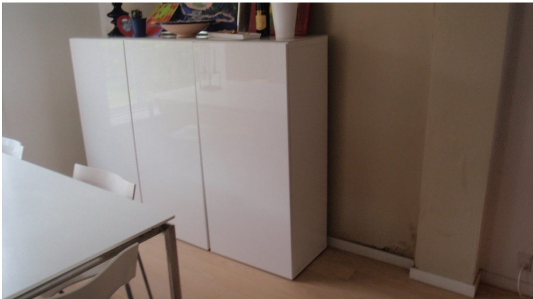
Foto 10 Fugt i stue/massiv mur
