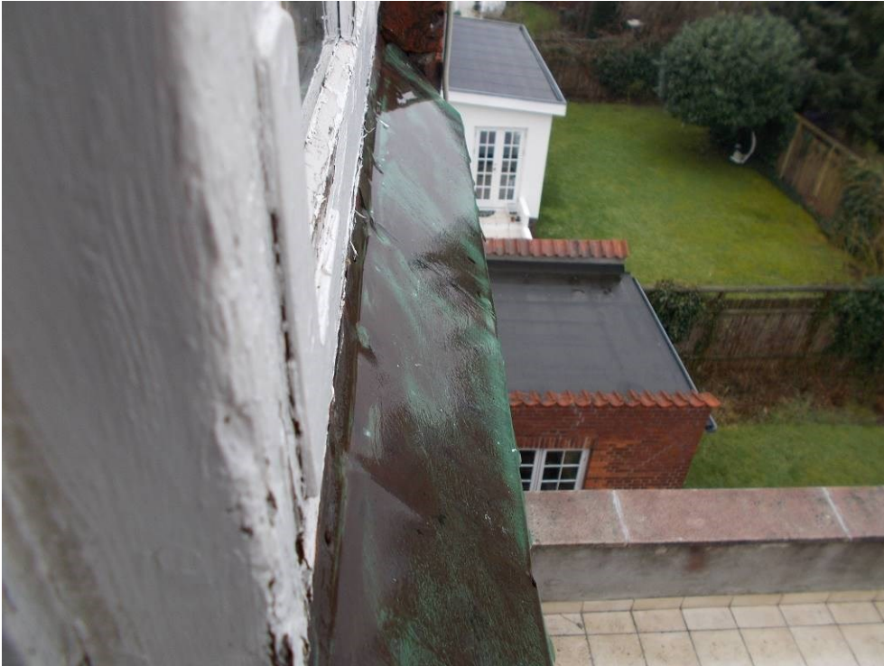
Utæthed mellem nyere hjørnebånd og rammetræ.
