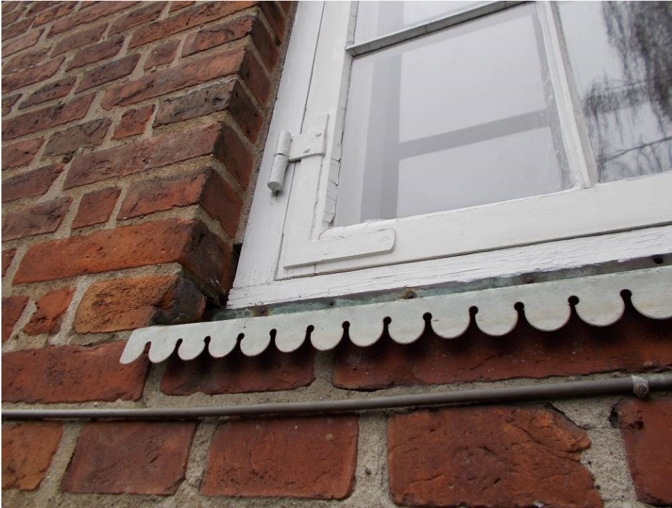
Defekt kalfatringsfuge af mørtel, kit og manglende sømning.
