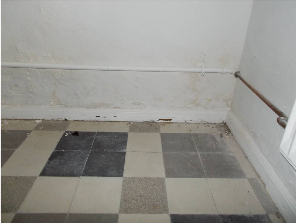
Kælderrum med råd i fodpanel.
