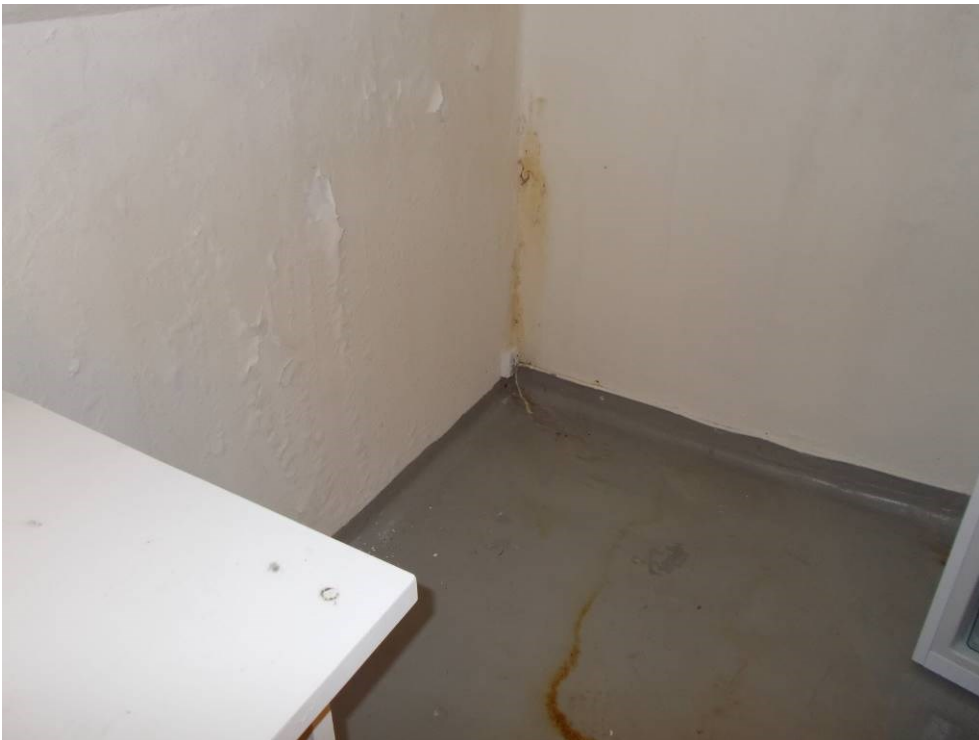
Kælderrum med tegn på indtrængning af vand udefra.
