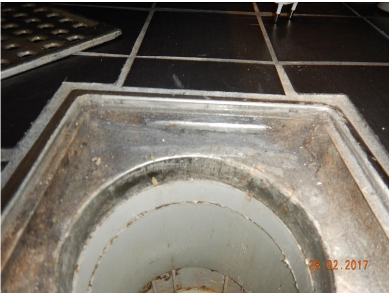
Rist til gulvafløb til venstre for dør er løftet, og der ses svag afstand mellem de to rammer fra henholdsvis det gl. gulv og den ny belægning i badeværelset.
