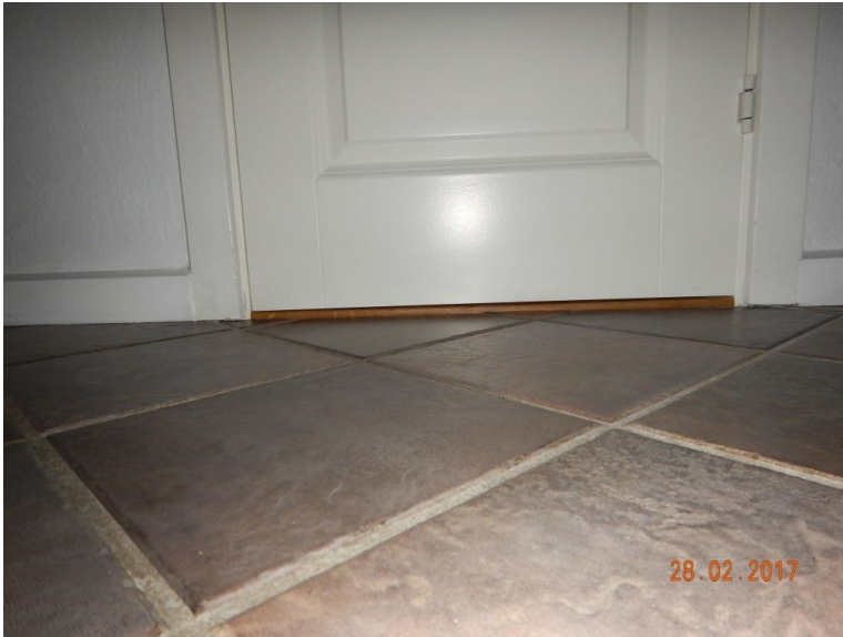
Bund af dør mellem det store badeværelse og gang, hvor der ikke forekommer ventilationsåbning.
