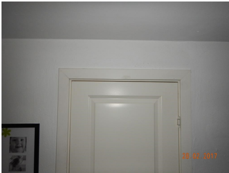
Top af dør mellem det store badeværelse og gang, hvor der ikke forekommer ventilationsåbning.
