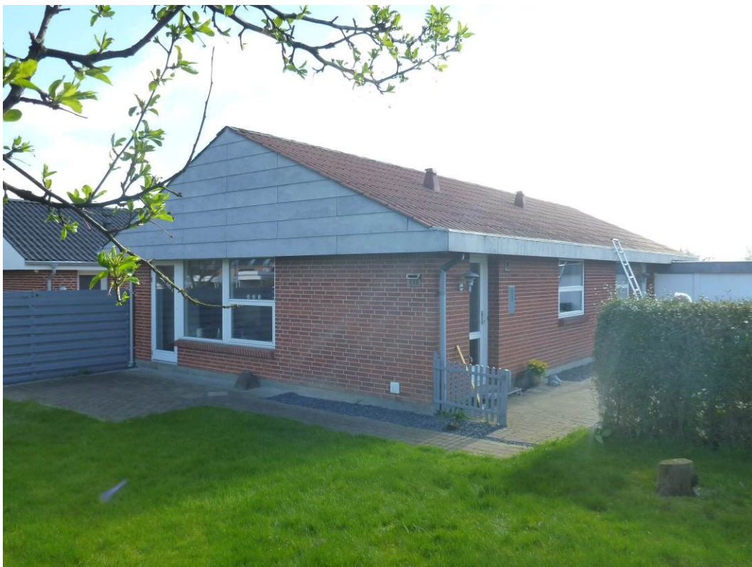
Foto 2 Oversigtsbillede set fra sydvest – bemærk terrassedøren i gavlen, og selve gavl- / sternbeklædningen.
