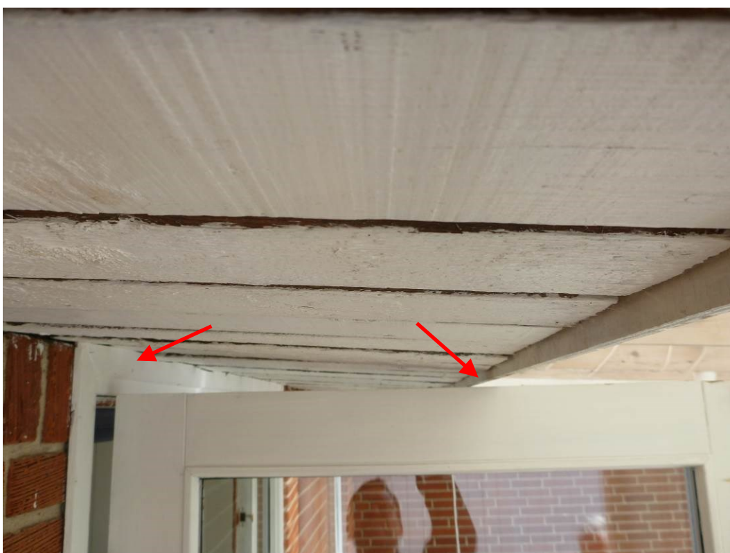
Foto 8 Terrassedøren i modsatte gavl (mod øst) kan frit åbnes – bemærk karmen op mod underbeklædningen, hvor der er afsluttet med en flad liste.
