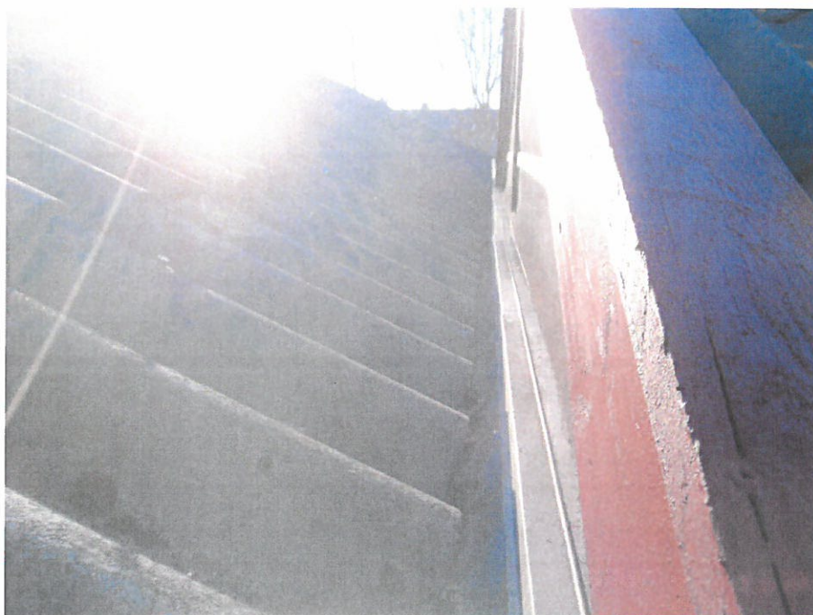
Foto 4 visende zinkinddækning mod tagrender – ikke tætsluttende
