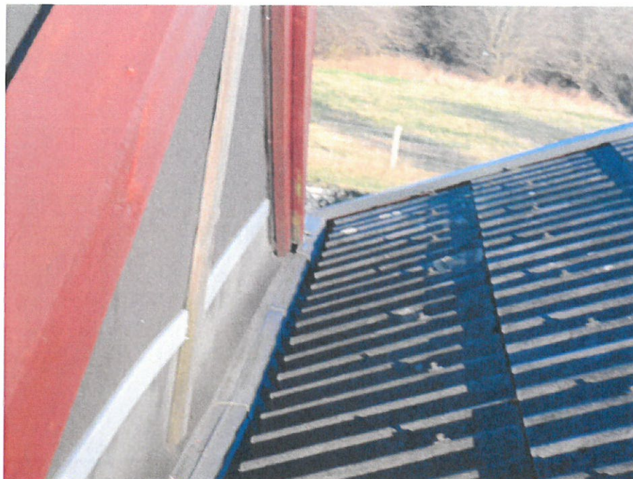
Foto 5 visende ingen beskyttelse af bræddebeklædning mod gavl – underpap
