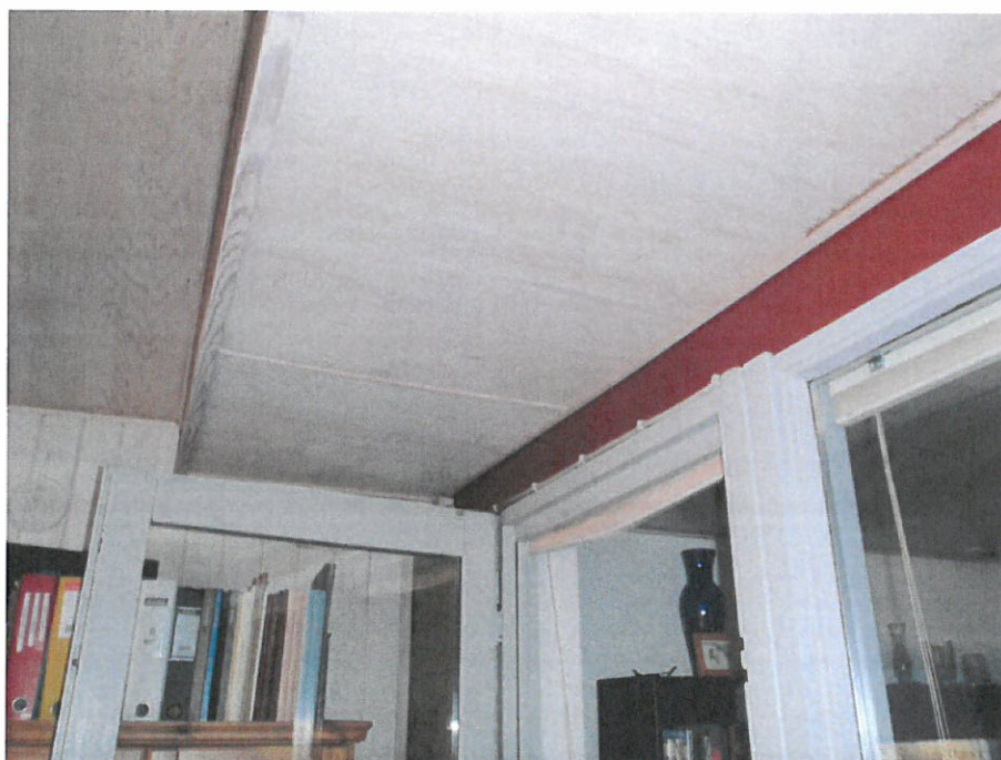
Foto 6 visende vandskjolder på udestueloft – midt på og th. under udhænget
