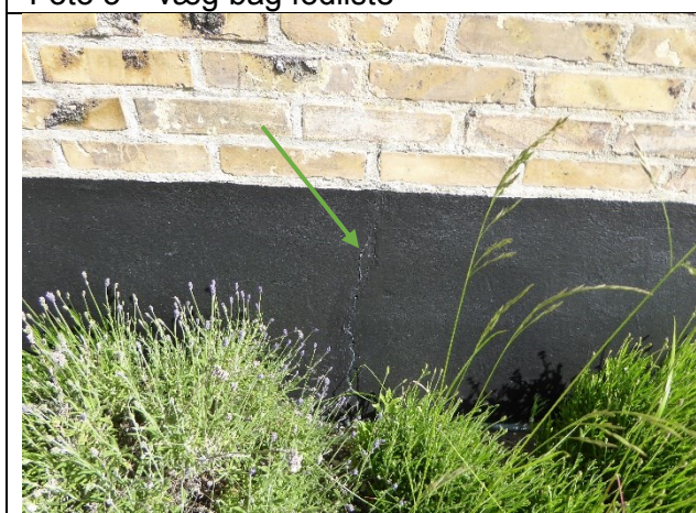
Foto 5 - revne i fundament mod syd
