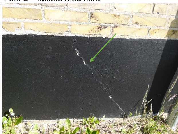
Foto 4 - revne i fundament mod syd
