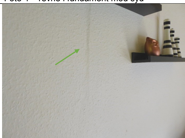
Foto 6 - tegn på forskydning i elementsamling
