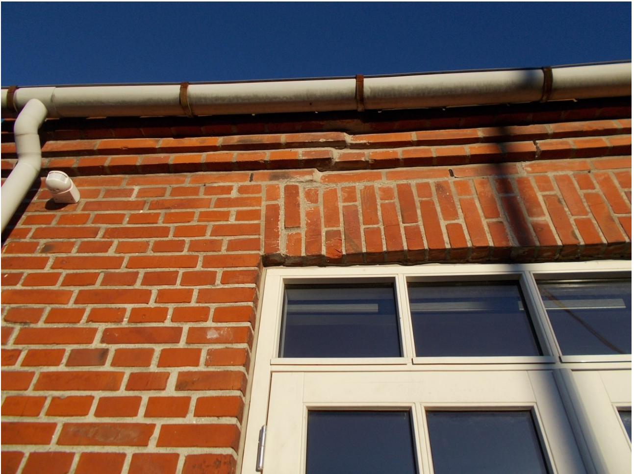
Forskydning over vindue i syd-facaden.
