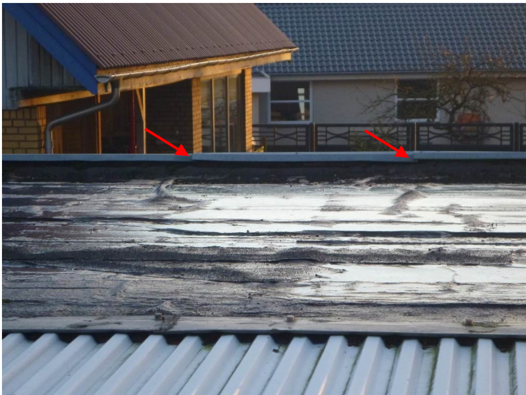
Foto 8 Tydelige tegn på en nedslidt tagpapbelægning, og løse inddækninger – set fra stigen ved den overdækkede terrasse via zoom på kamera.
