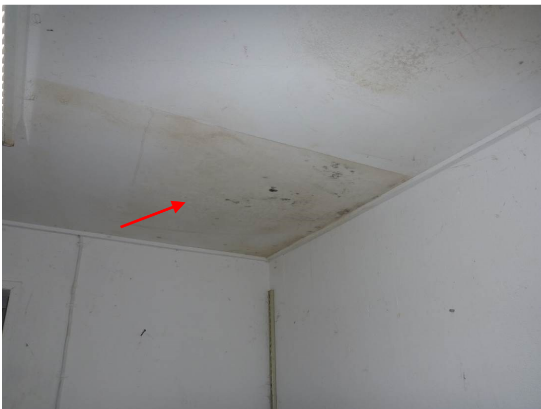
Foto 9 Fugtskjolder og let skimmelvækst på loftplader, her i det sydvestlige rum.
