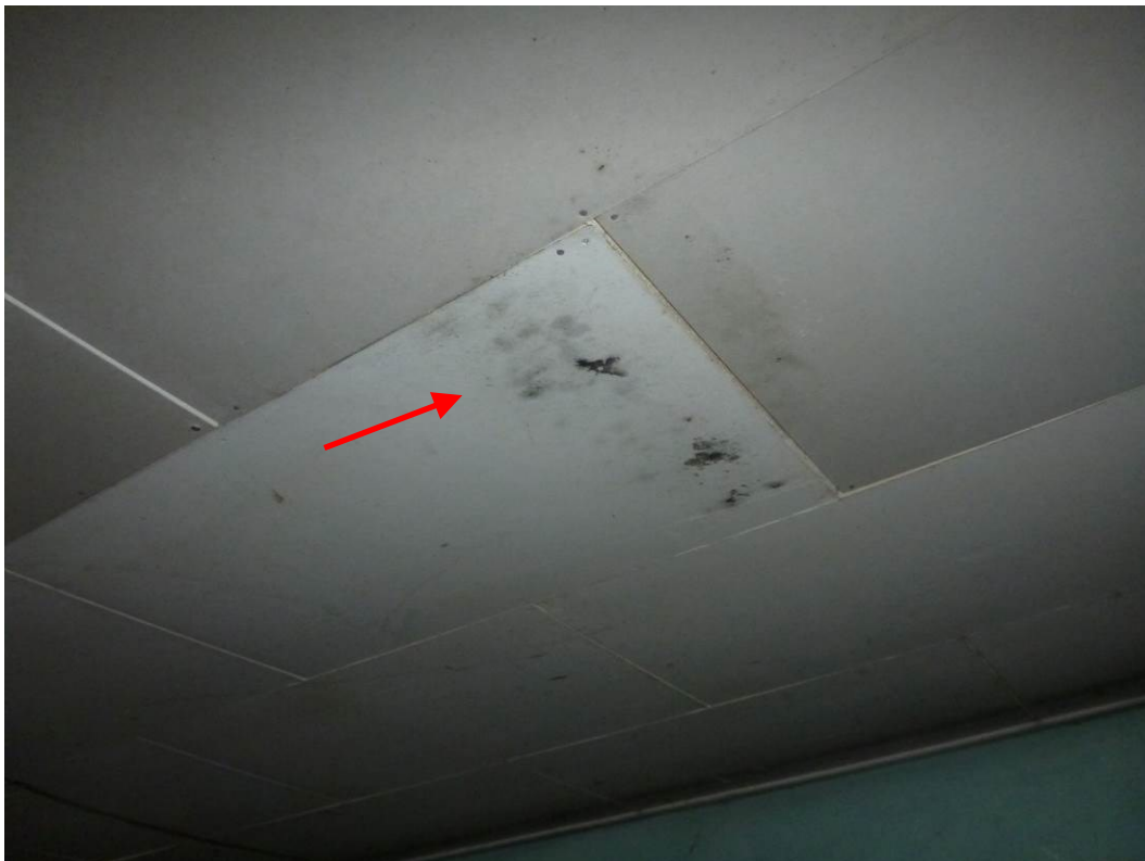
Foto 10 De samme skjolder ses i garagen – bemærk at der er udskiftet loftplader.
