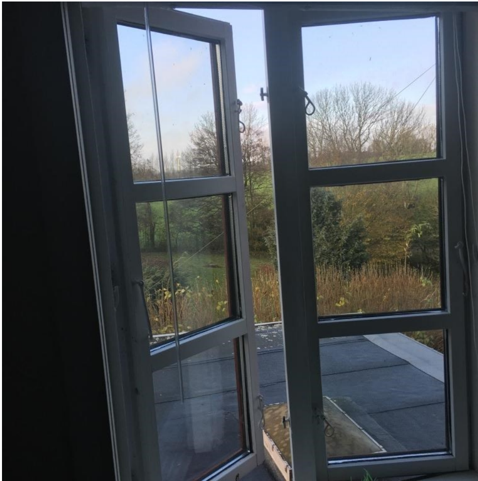
Værelsesvindue, som KK oplyste ikke kunne åbnes, men som kunne åbnes.
