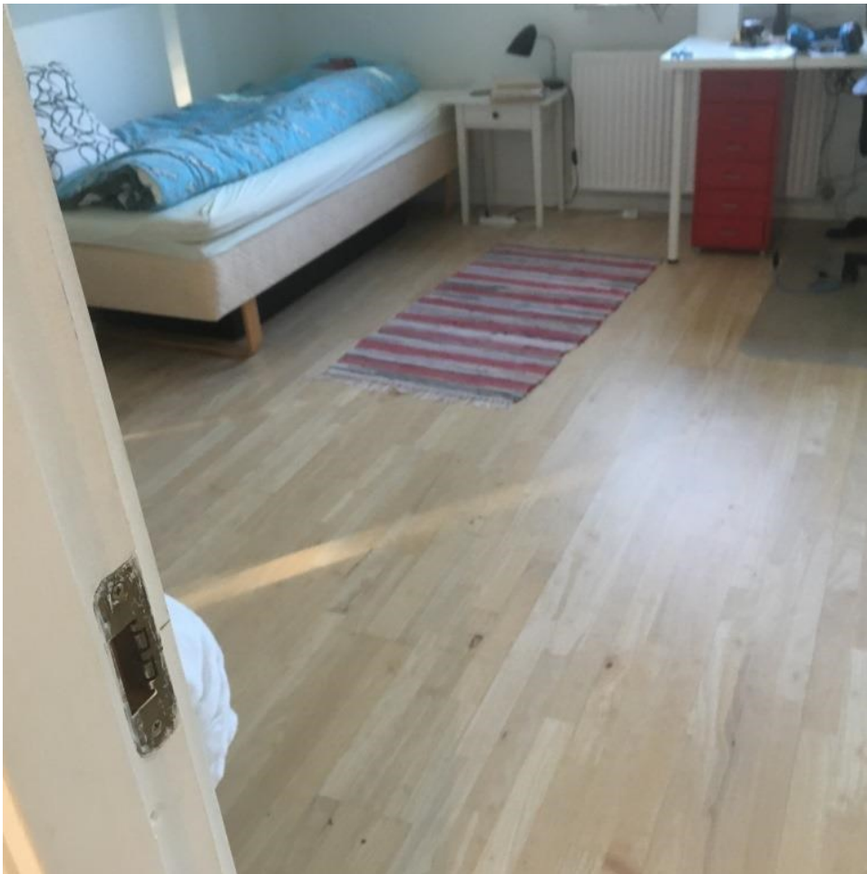
Gulvene i værelse på 1. sal er et parketgulv, antageligvis udlagt på en spånplade- belægning. Gulvene forekommer lettere gyngende.
