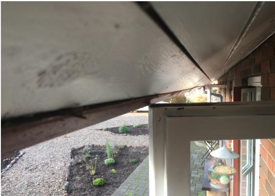
Når vinduer mod gårdsplads åbnes, støder disse på undersiden af sternbræt langs udhæng.
