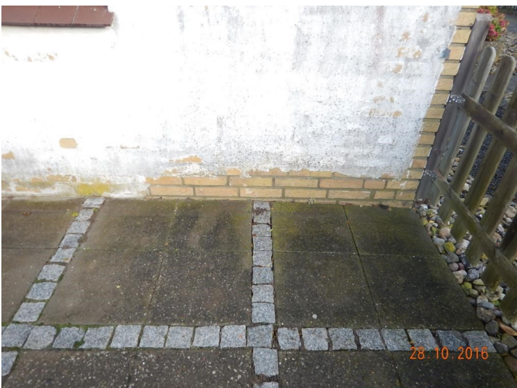
Fugtskader i nederste del af gavlmuren.
