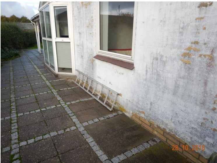
Fugtskader i nederste del af gavlmuren.
