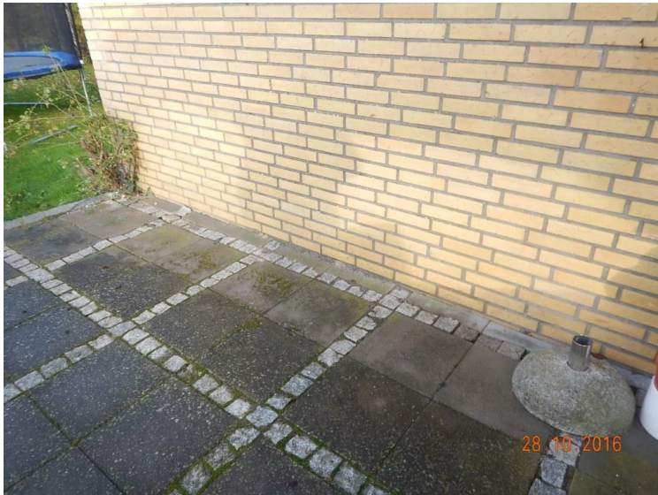
Flisebelægning er ført over sokkelhøjde.
