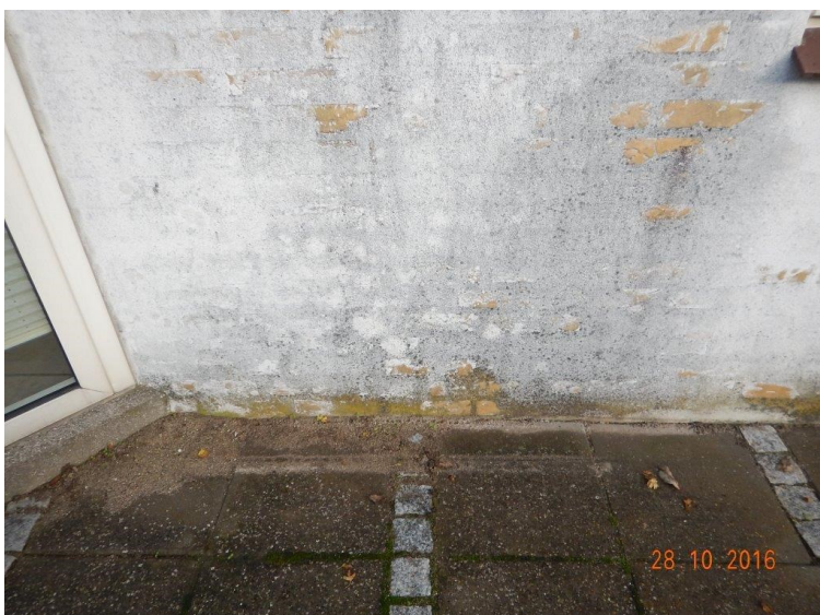
Flisebelægning er ført over sokkelhøjde.
