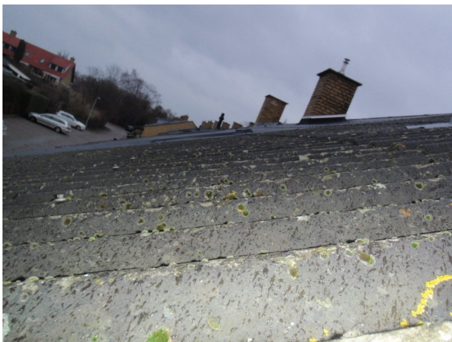
Foto 6 visende bølgeeternittagplader – Nyere og ældre afskalninger
