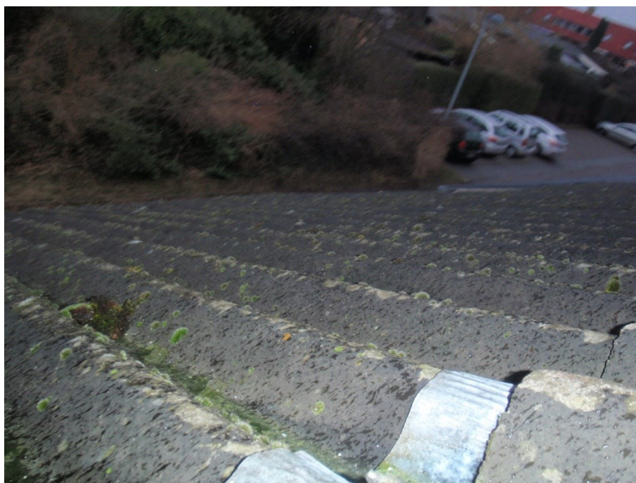
Foto 3 visende bølgeeternittagplader – Afskalning bl.a. bølgetoppe
