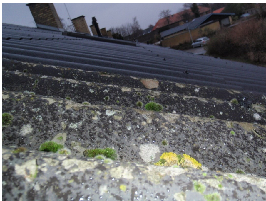
Foto 4 visende bølgeeternittagplader – Afskalning bl.a. bølgetoppe
