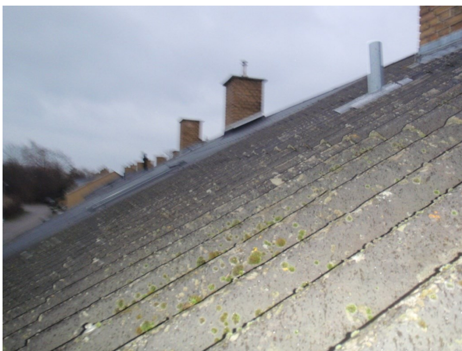
Foto 5 visende bølgeeternittagplader – Nyere og ældre afskalninger
