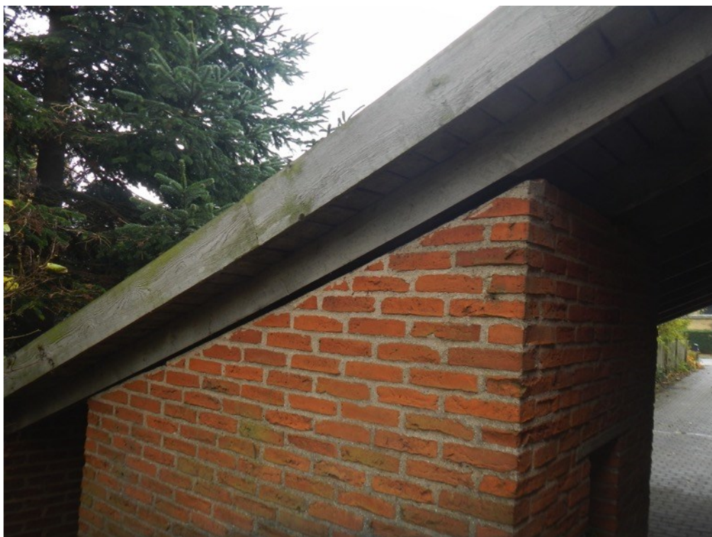
Foto nr. 4 Kernen vrider lidt i forhold til det overliggende bjælkespær. Kosmetisk skade, vurderes ikke at have nogen praktisk betydning. Der ses ingen følgeskader
