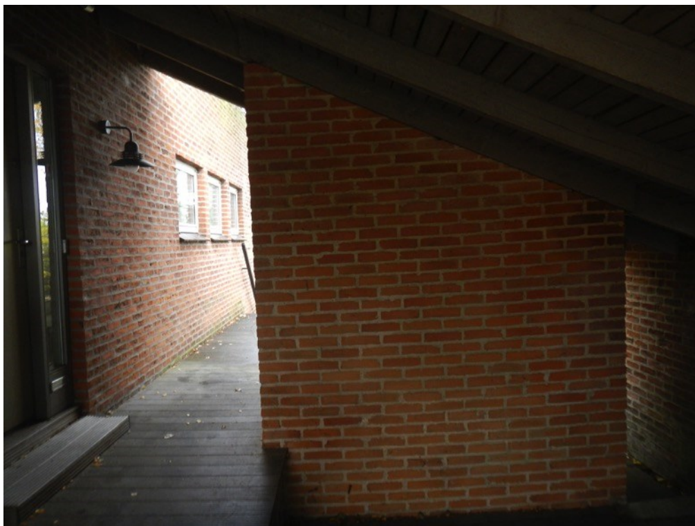
Foto nr. 3 Muret kerne i carporten har sat sig lidt. Hælder ca. 2 cm mod venstre, målt over murværkets samlede højde
