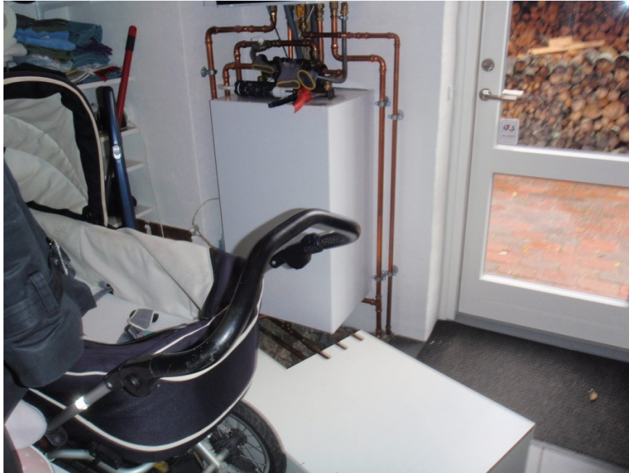
Foto 7 visende rørkasse under gasfyr m.m.
