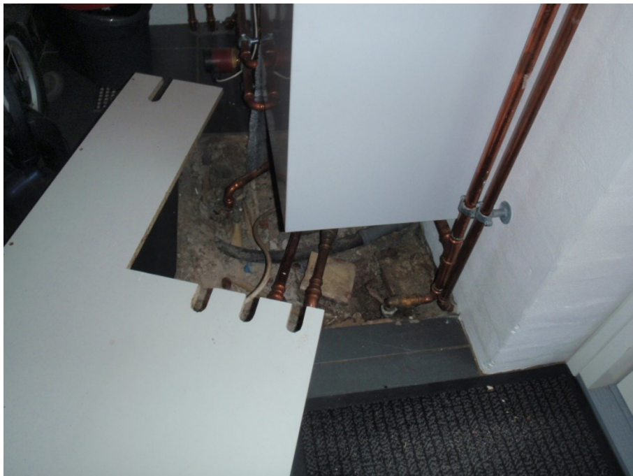
Foto 8 visende manglende finish/afslutning ved gulv og rør
