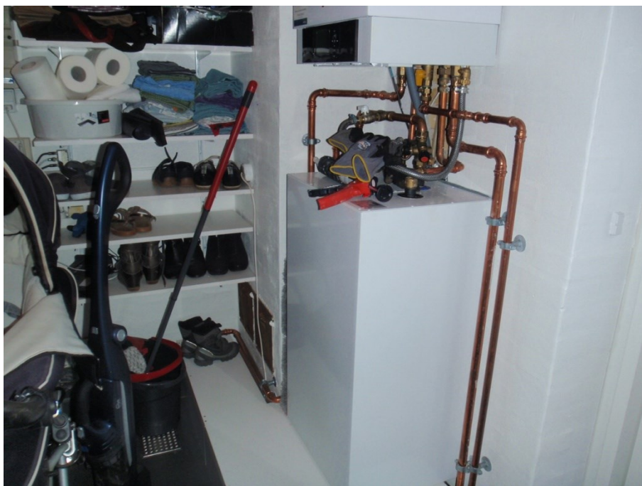
Foto 5 visende rørkasse under gasfyr m.m.
