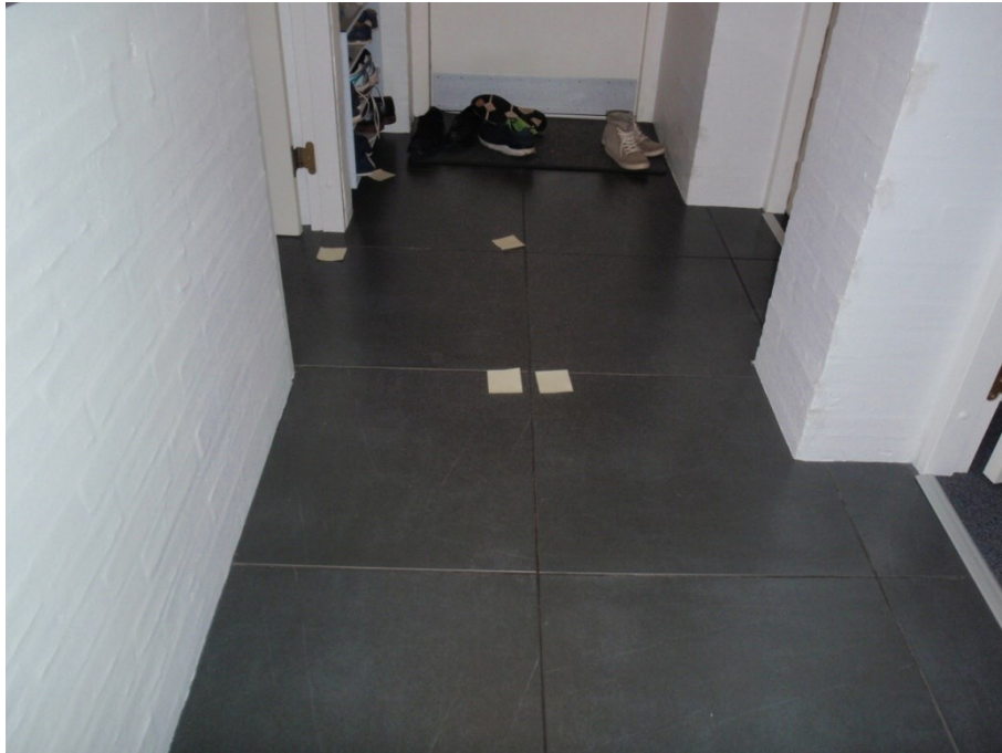
Foto 1 visende hultlydende klinker i gang – bl.a. manglende vedhæftning ved flisekanterne
