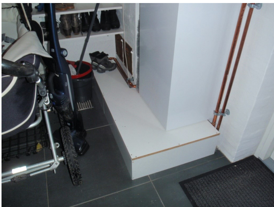
Foto 6 visende rørkasse under gasfyr m.m.
