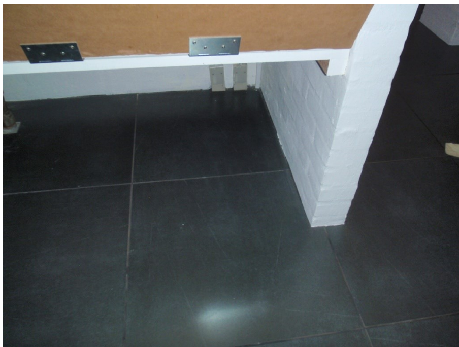
Foto 3 visende brønd/afløb skjult under flisegulv i gang – ikke synlig
