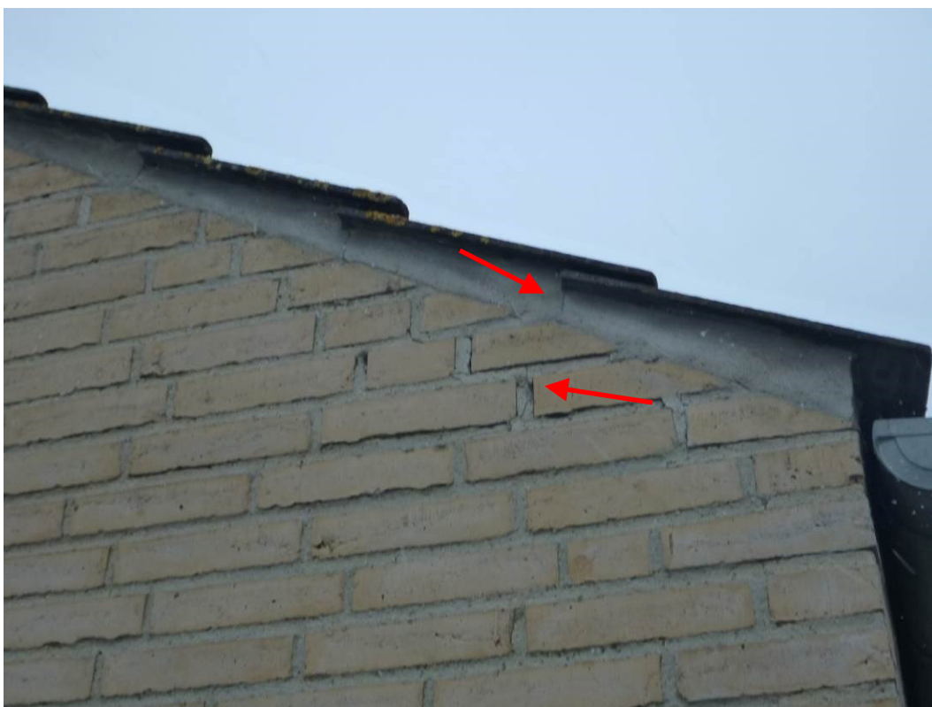
Foto 10 På de vestvendte gavle, ses der også lidt revnedannelser langs forskælningen.
