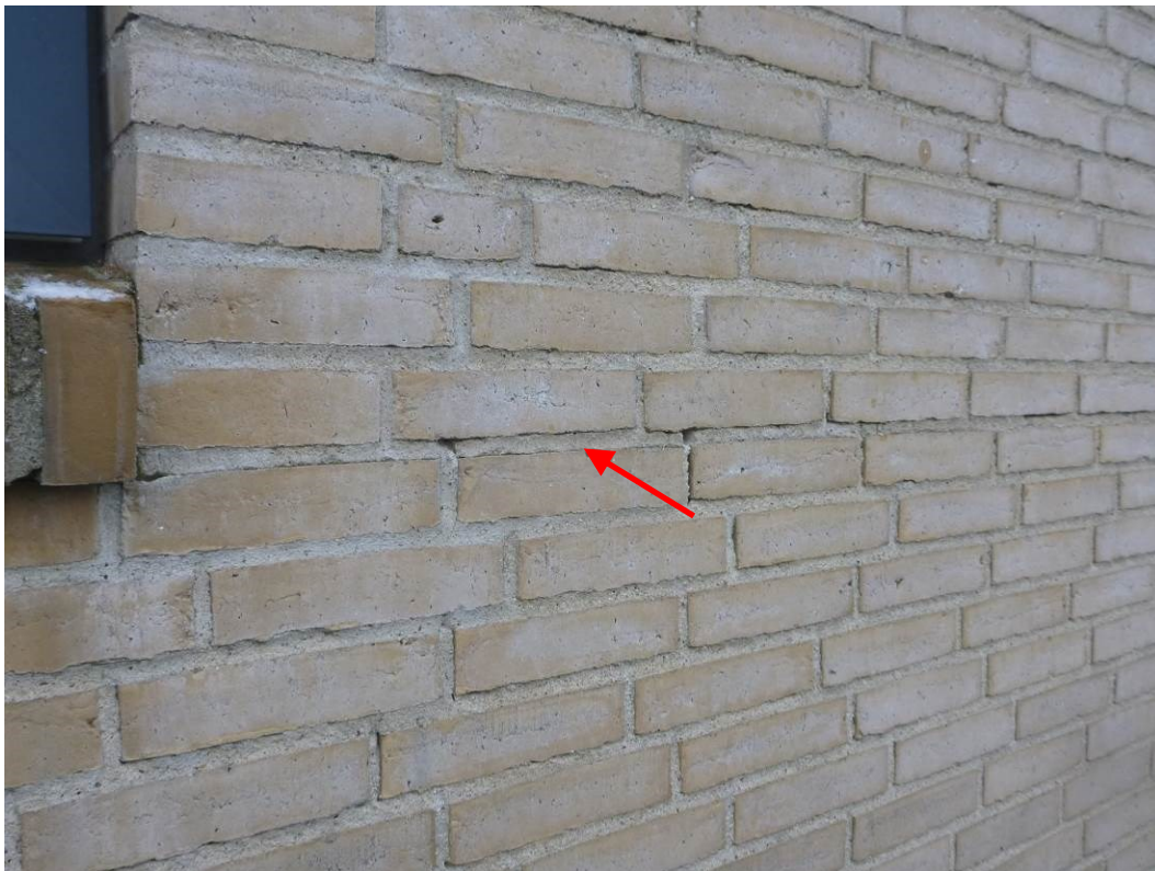
Foto 12 Ved samme vindue mod syd, ses der en vandret revnedannelse i murværket (kun i murværksfugen).
