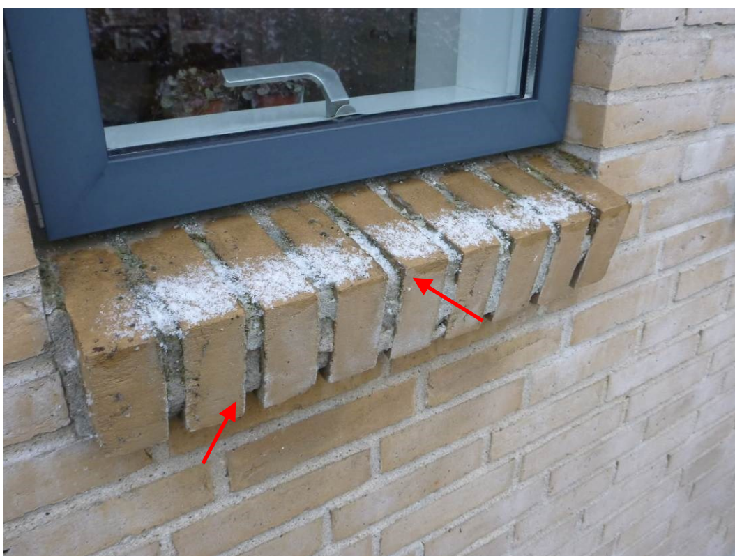
Foto 14 Mod syd er der løse og udfaldne fuger på sålbænke, her ud for opholdsstuen – bemærk at sålbænkene er afsluttet glat med murfalsene.
