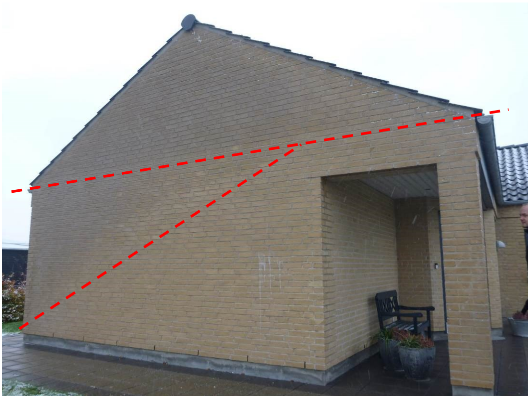
Foto 6 På gavlen mod øst, er det særligt på gavltreanten at der ses forvitrede fuger – bemærk også farveforskellen på murværket.
