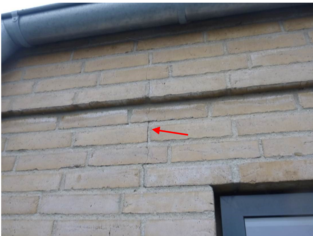
Foto 11 Mod syd ses der en revne over vinduet, op gennem murværket.
