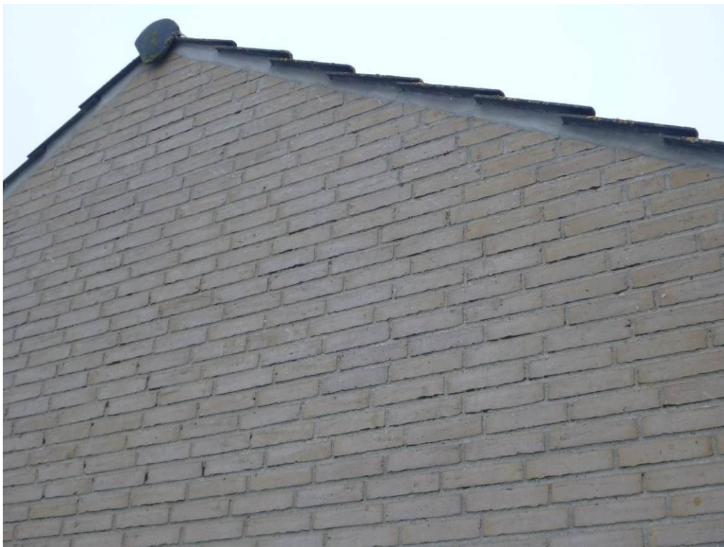
Foto 9 På de vestvendte gavle, her ud for opholdsstuen, er det særligt på gavltrekanen der ses løse, forvitrede og udfaldne fuger.
