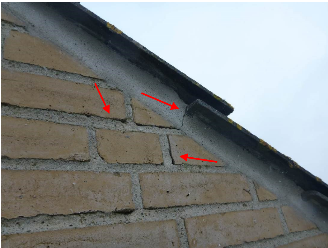
Foto 7 Øverst på østgavlen, ses der revner i såvel fuger som i selve forskælnnigen.
