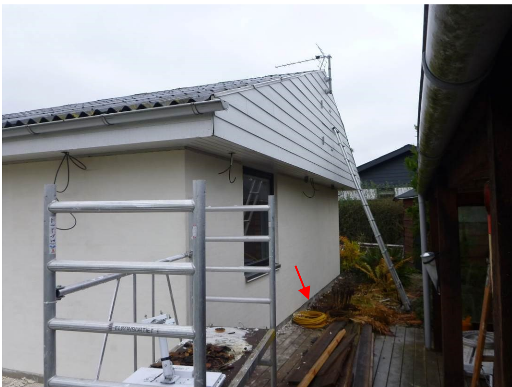
Foto 3 Gavlen mod nord set fra nordøst – pilen markerer ristens placering i soklen.
