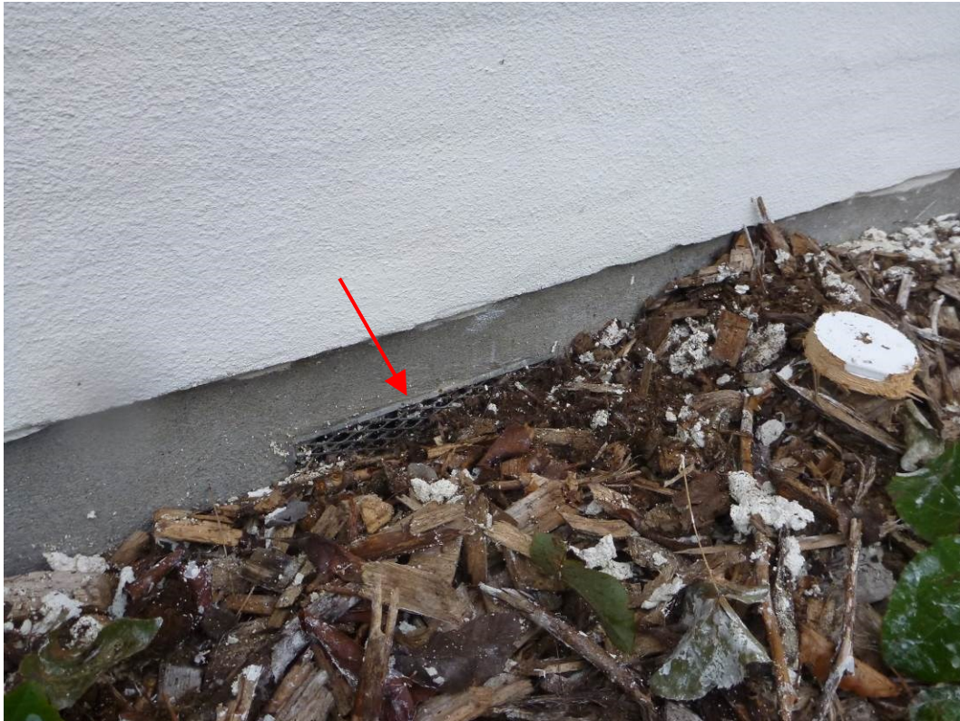
Foto 5 Flere udluftningsriste sidder helt tæt ved, og enkelte steder under terrænen – her mod vest.
