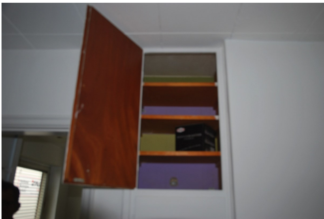
Foto nr. 4 Mindre fugtskjolder på lofter i indbyggede skabe
