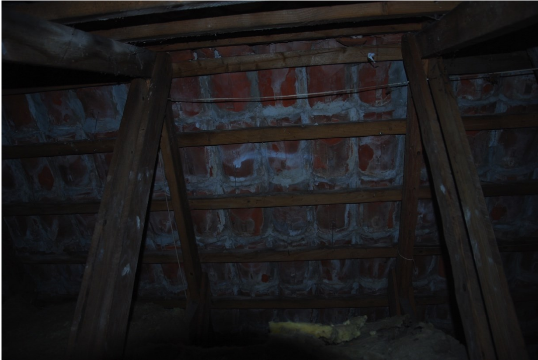
Foto nr. 5 Understrygning af tagsten
