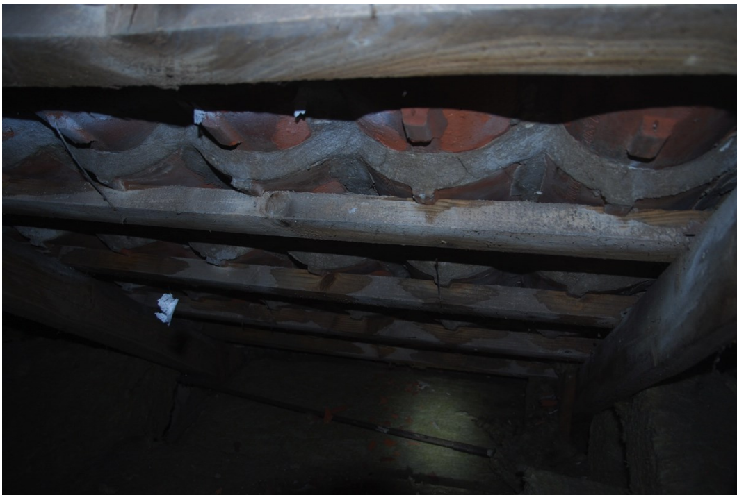
Foto nr. 6 Taglægter ses med støv og mindre skjolder
