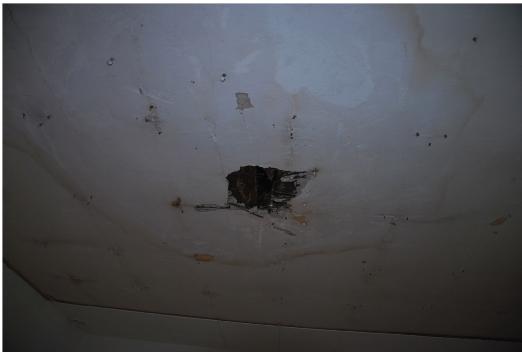
Foto nr. 3 Fugtskader på loft i stue, bag det oprindelige cellutex-loft
