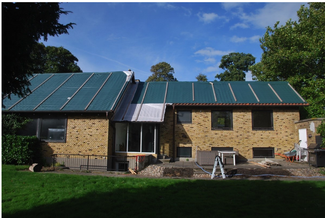
Foto nr. 2 Ejendommen, set fra syd. Hele taget er overdækket med presenninger
