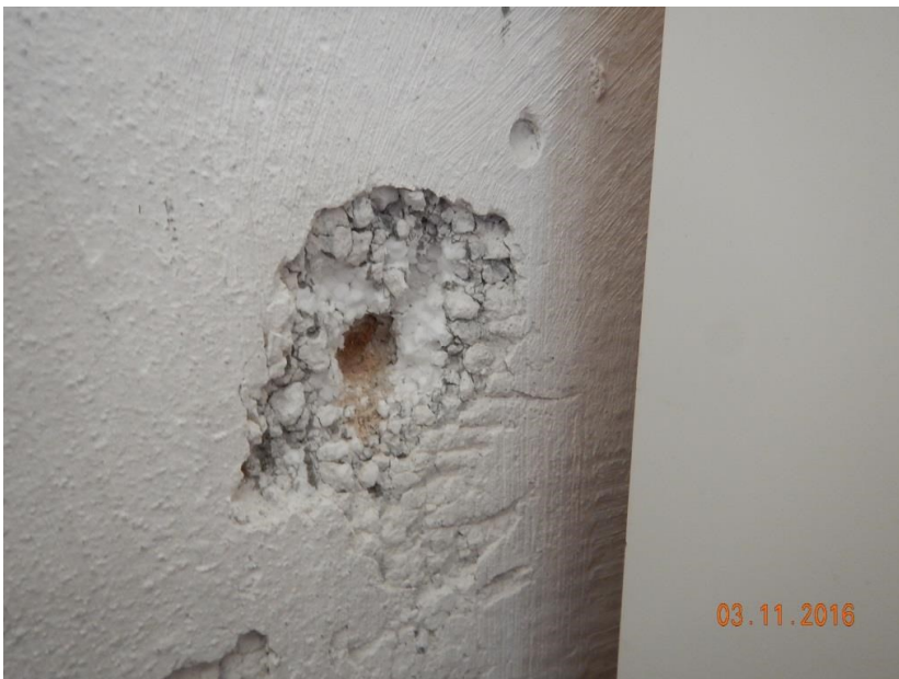
Kælderydervæg i værelse, hvor KK har lavet hul i flamingopladerne ind til kælderbagmuren. Dette hul var ikke tilstede i forbindelse med BB's besigtigelse af ejendommen for udarbejdelse af tilstandsrapporten.
