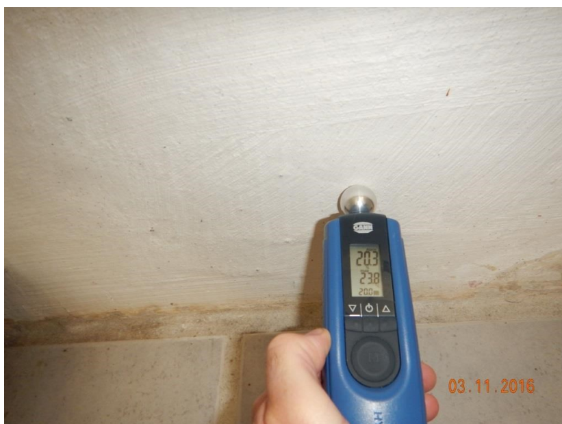
Fugtmåling af flamingobeklædt kælderbagmur i værelse nr. 1, som viser fugt i kældervæggene.
