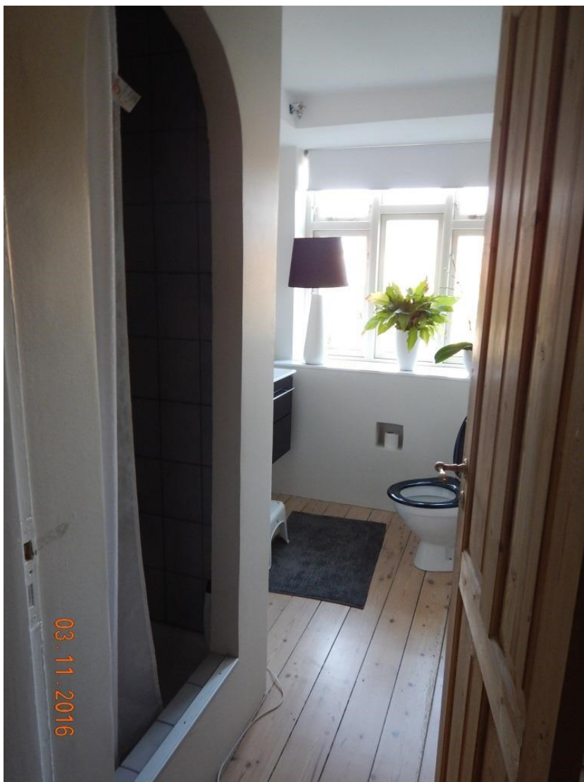
Badeværelse på 1. sal, hvor afløb fra håndvask og bruseniche er tilsluttet udvendigt nedløbsrør.
