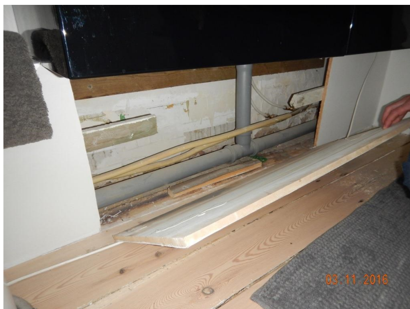
Efter demontering af inddækning under badeværelsesmøbel ses afløbsinstallationerne fra bruseniche og håndvask.
