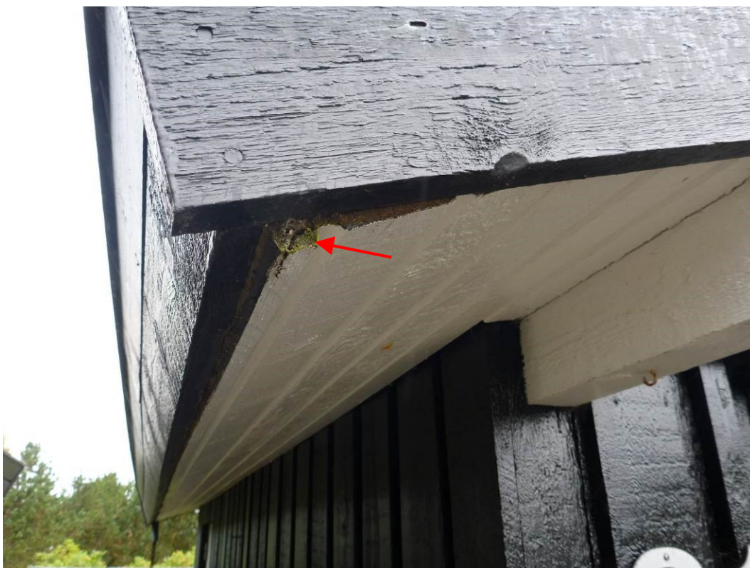
Foto 11 Underbeklædningen, her på garagen, ses også at hænge ved gavlene.
