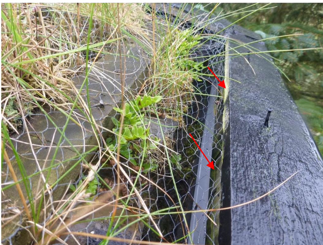
Foto 12 Fra tagrenden ses der fugt på sternbræddernes top og bagside – bemærk også de fyldte tagrender samt den begrænsede / besværlige mulighed for oprensning
