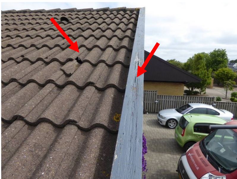
Foto 9 Defekt/revnet tagsten, samt ned- brydning i dækbræt ved øst gavl.
