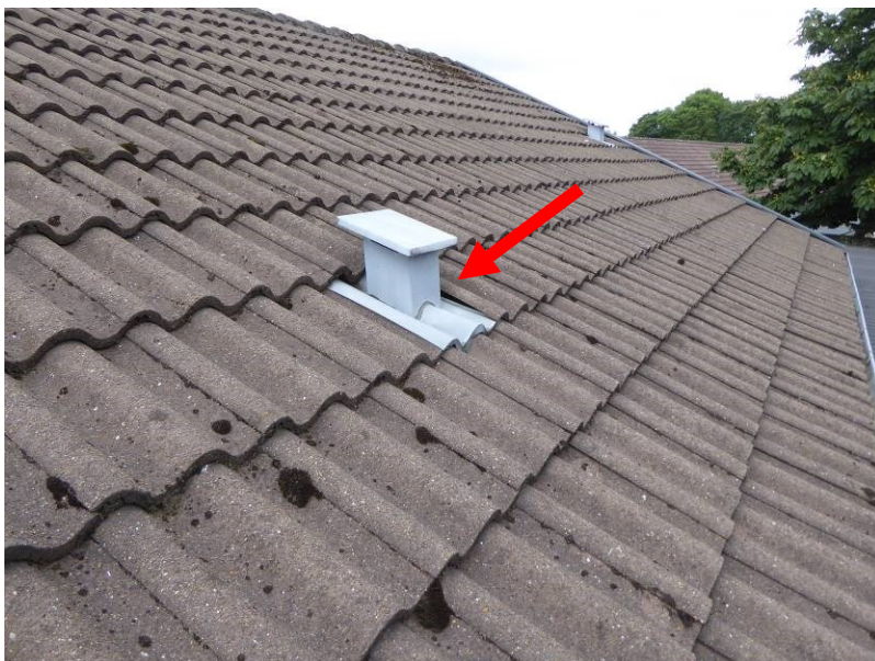
Foto 4 Utæthed ved taghætte nr. 1 mod nord.
