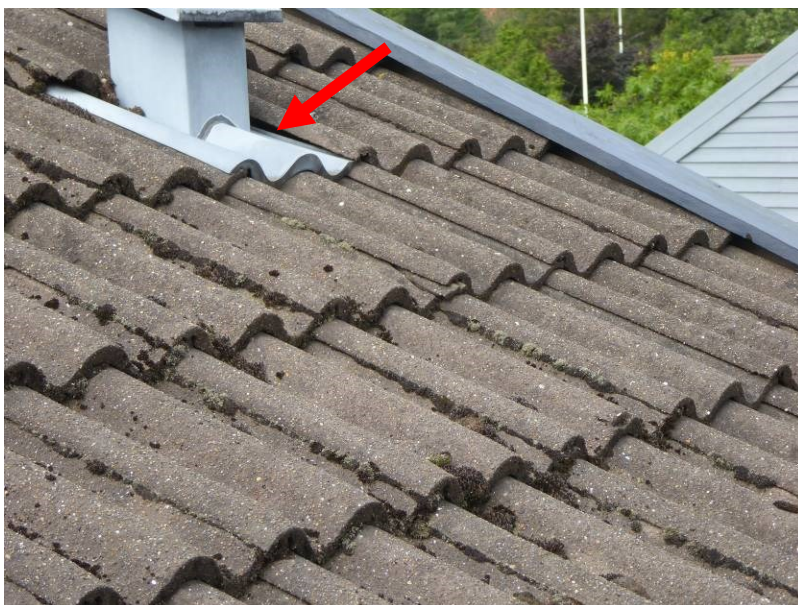
Foto 5 Utæthed ved taghætte nr. 2 samt revnet tagsten mod nord.
