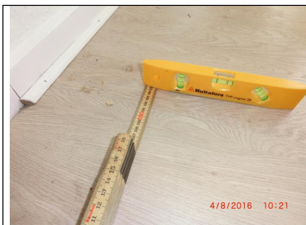
'19 Skævt gulv bygning B
