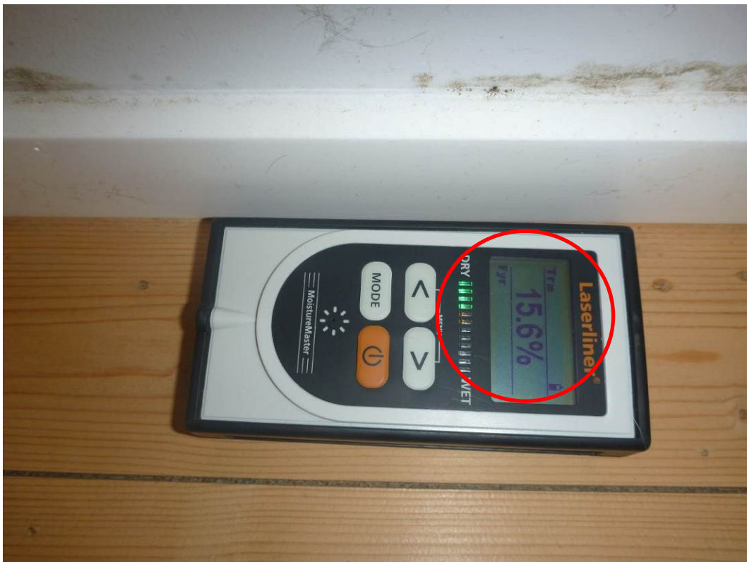
Foto 8 Fugtmåling på gulvet langs ydervæggen viser flere steder ca. 15 %.
