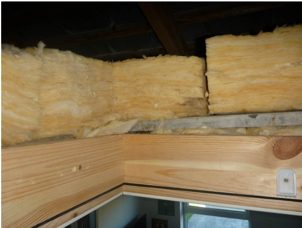
Foto 14 Fra loftlemmen ses der tydeligt isolering på loftet.
