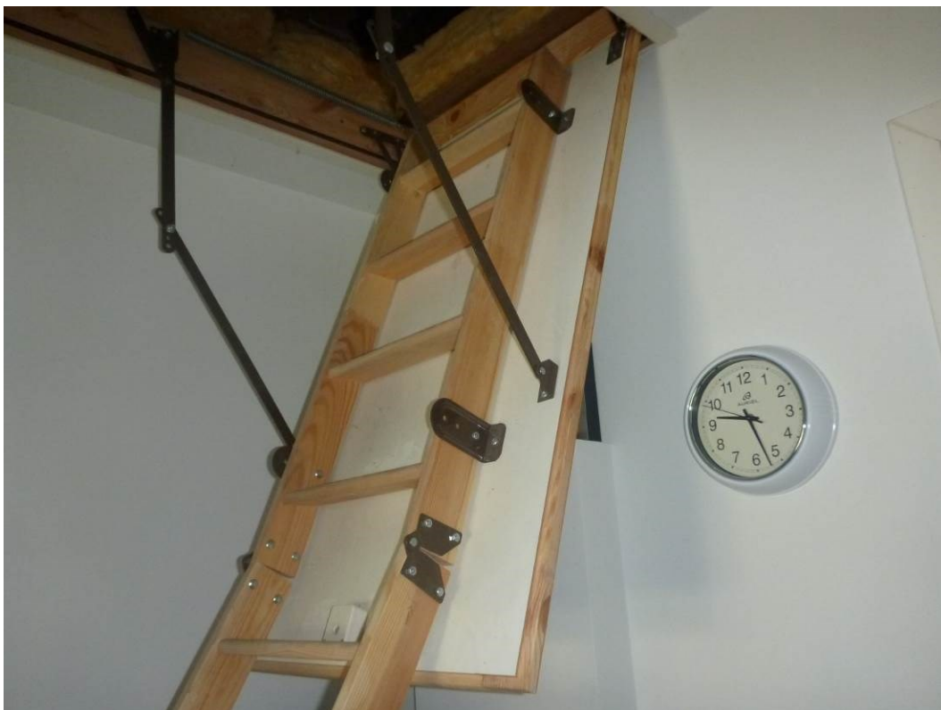
Foto 13 Loftlemmen i det nordvestlige værelse ses at være udført med tætningslister og et tyndt lag isolering.
