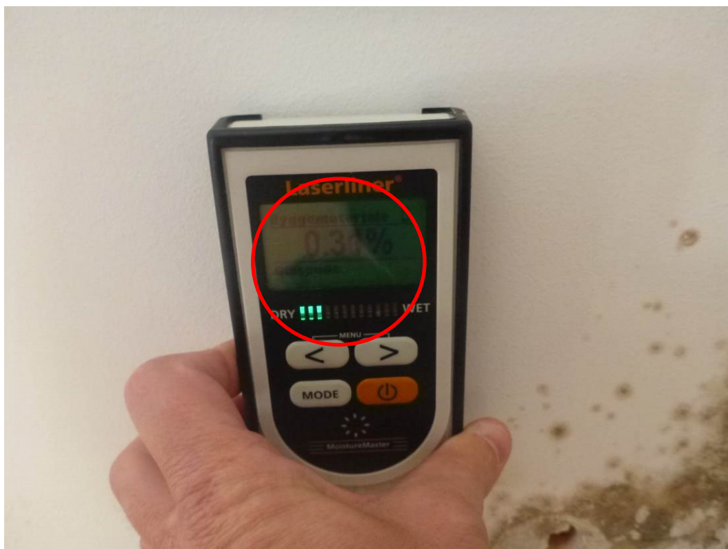
Foto 9 Fugtmåling på væggen mod nord, viser flere steder under 1 %.
