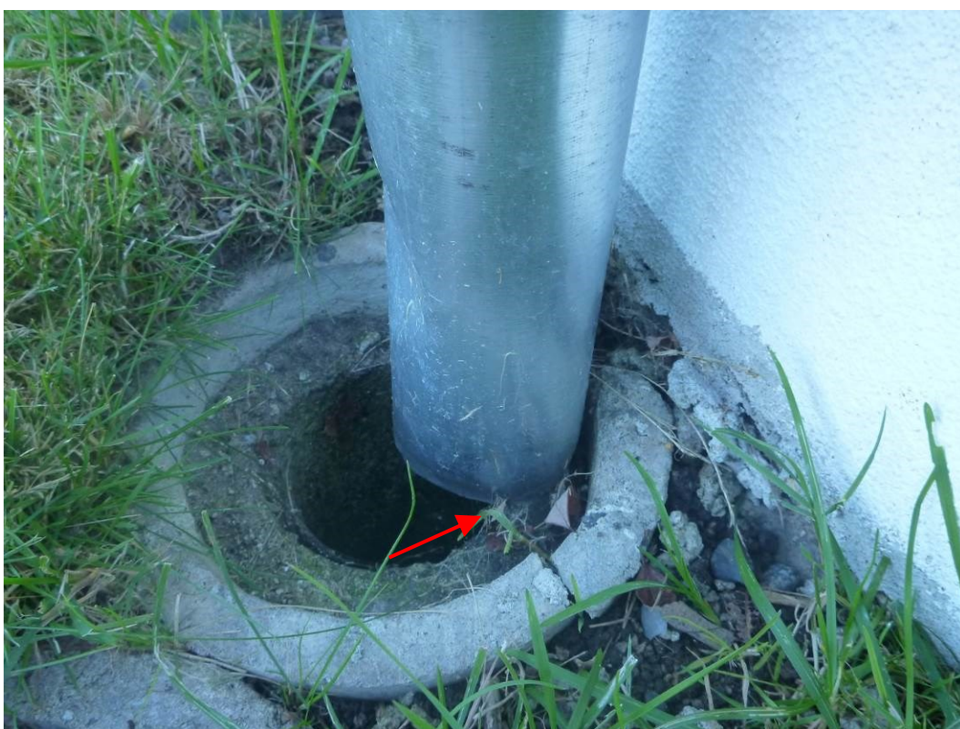
Foto 18 Tagnedløbet mod vest (ud for det nordvestlige værelse) er ikke centreret, og tagbrøndens bagkant, er lidt afskallet.
