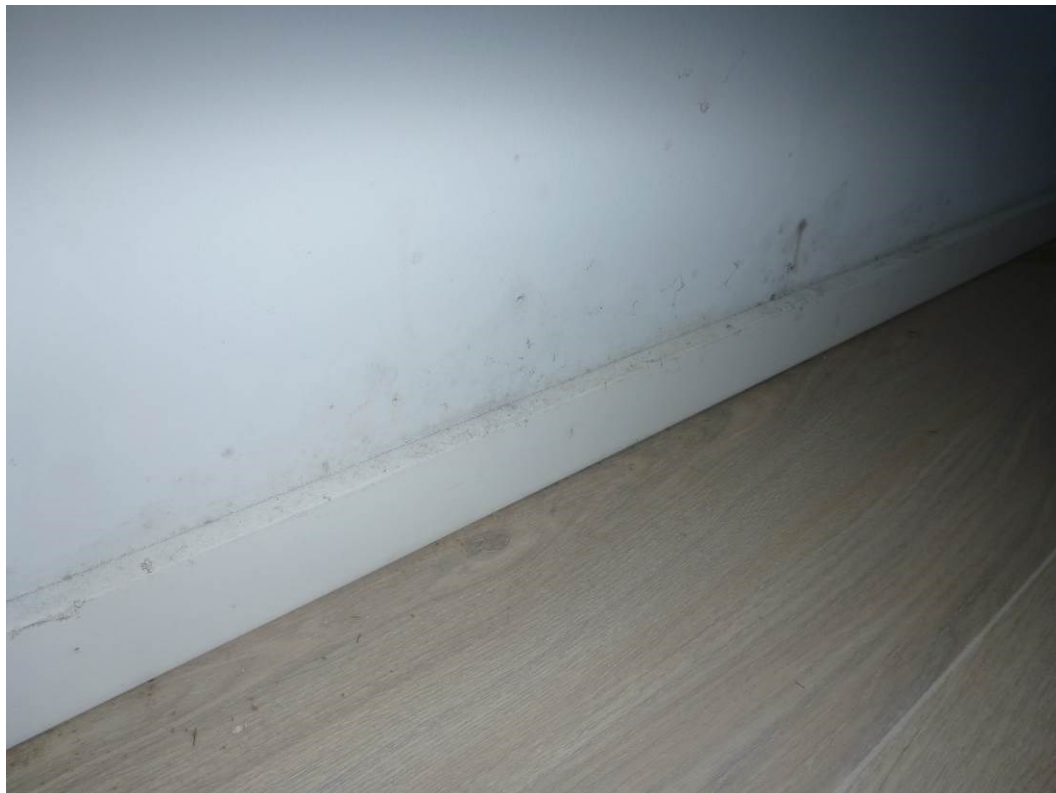
Foto 10 Nederst langs forsatsvæggen i det nordvestlige værelse (tidligere garage) ses der fugtskjolder langs fodlisten.
