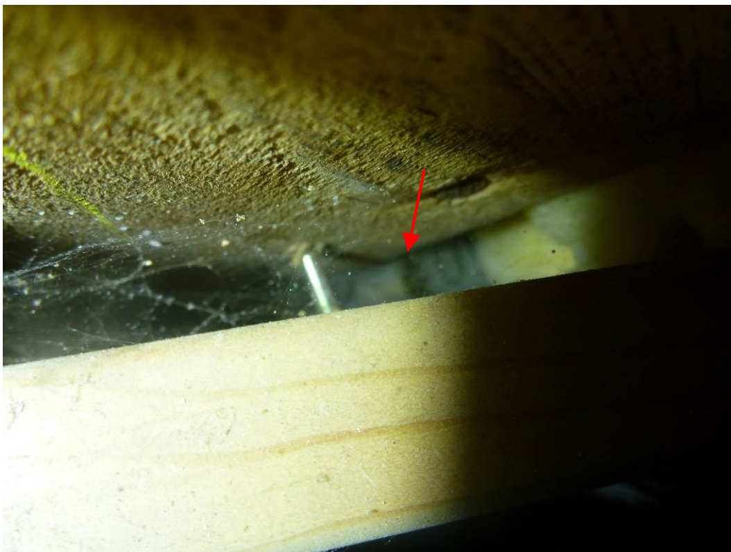
Foto 15 Fra loftlemmen ses der mellem karm og spærfod, synligt dampspærre over loftet (desværre lidt utydeligt på billedet).
