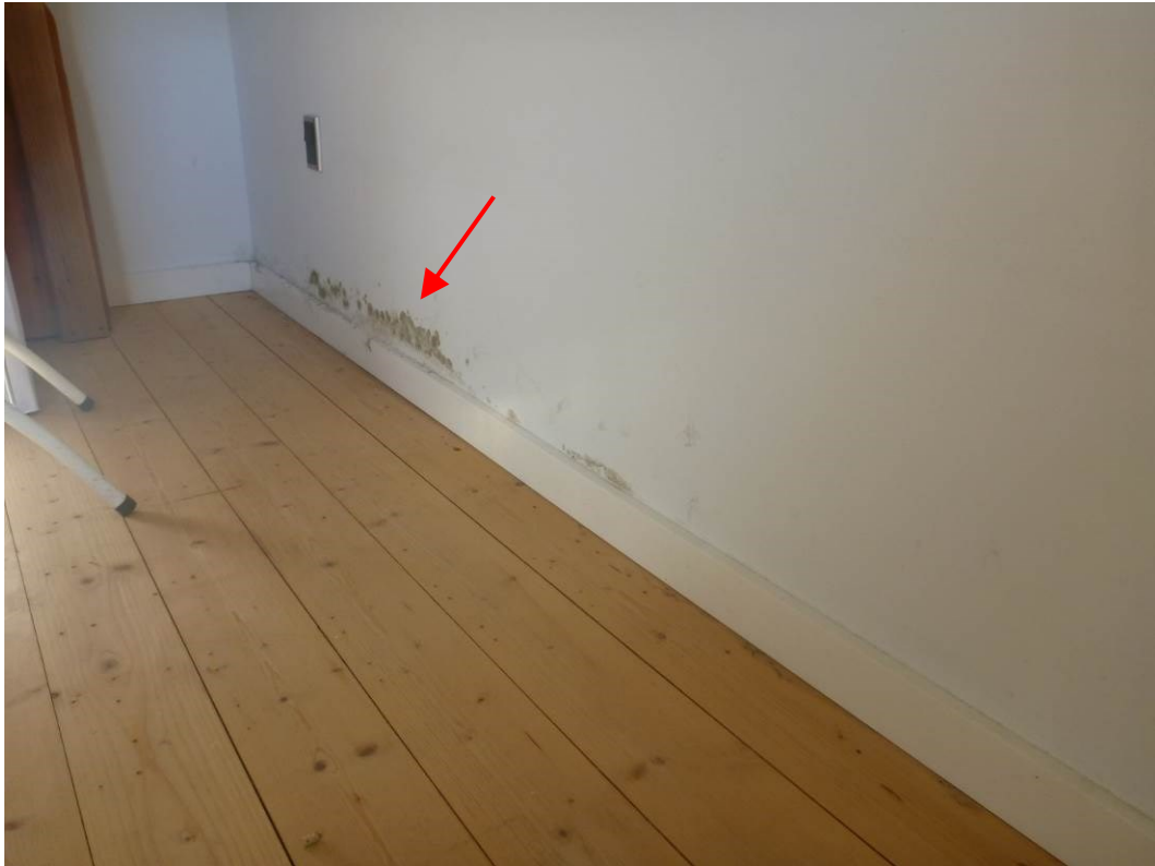
Foto 5 Fugtskjolder nederst langs fodlisten, på den nordlige ydervæg.
