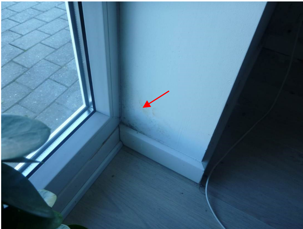
Foto 16 I lysningen mod nordvest, i værelset, ses der fugtskjolder nederst.
