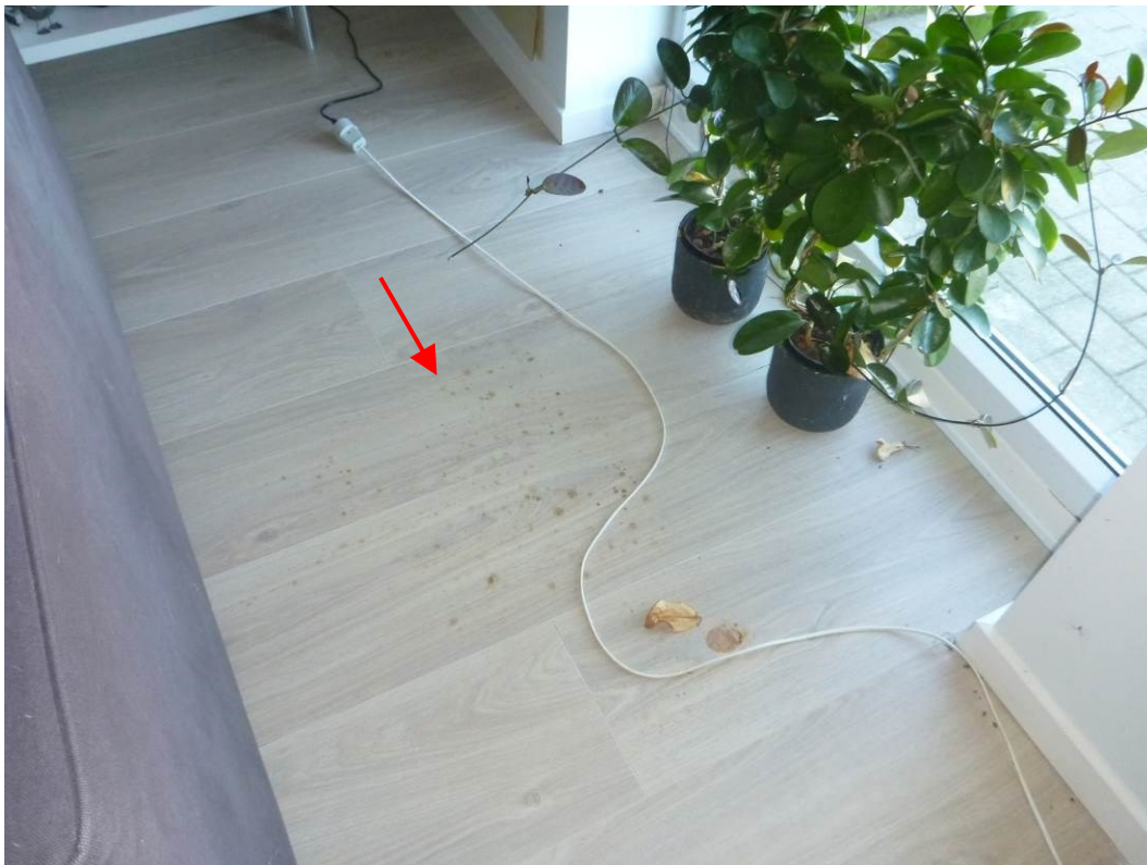
Foto 12 På gulvet foran vinduespartiet mod vest, ses der mugdannelse.
