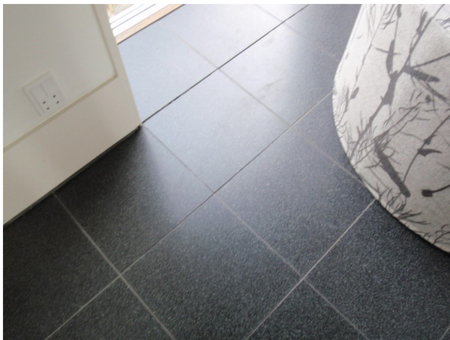
Foto 15 visende revne ved flisefuge i gulvet ved lysning
