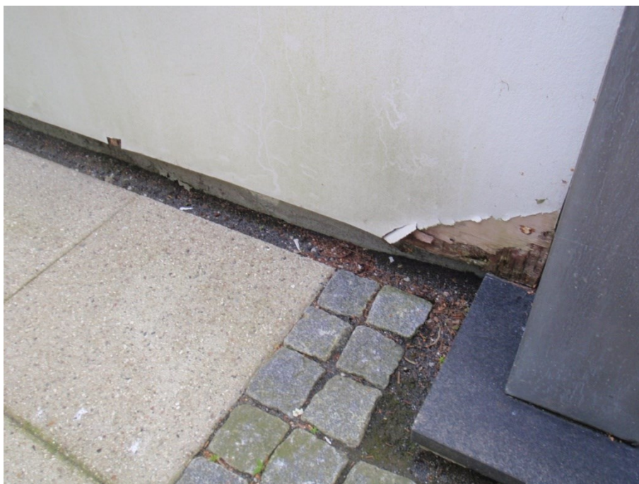
Foto 7 visende skadet pladebeklædning – vestgavl
