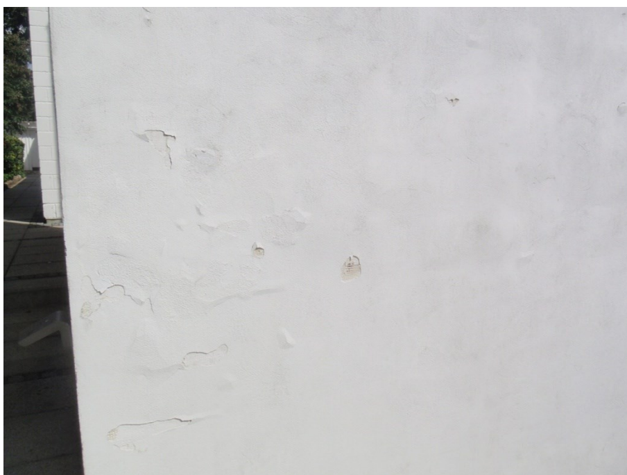
Foto 12 visende skadet puds læmur – syd
