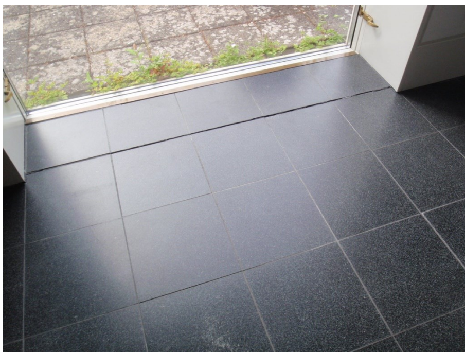
Foto 14 visende revne ved flisefuge og lidt forsætning i vindues/skydedørslysning i stuen
