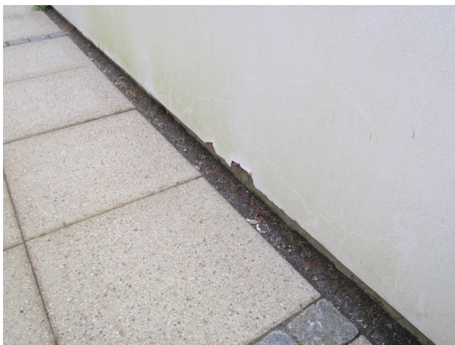
Foto 6 visende skadet pladebeklædning – vestgavl
