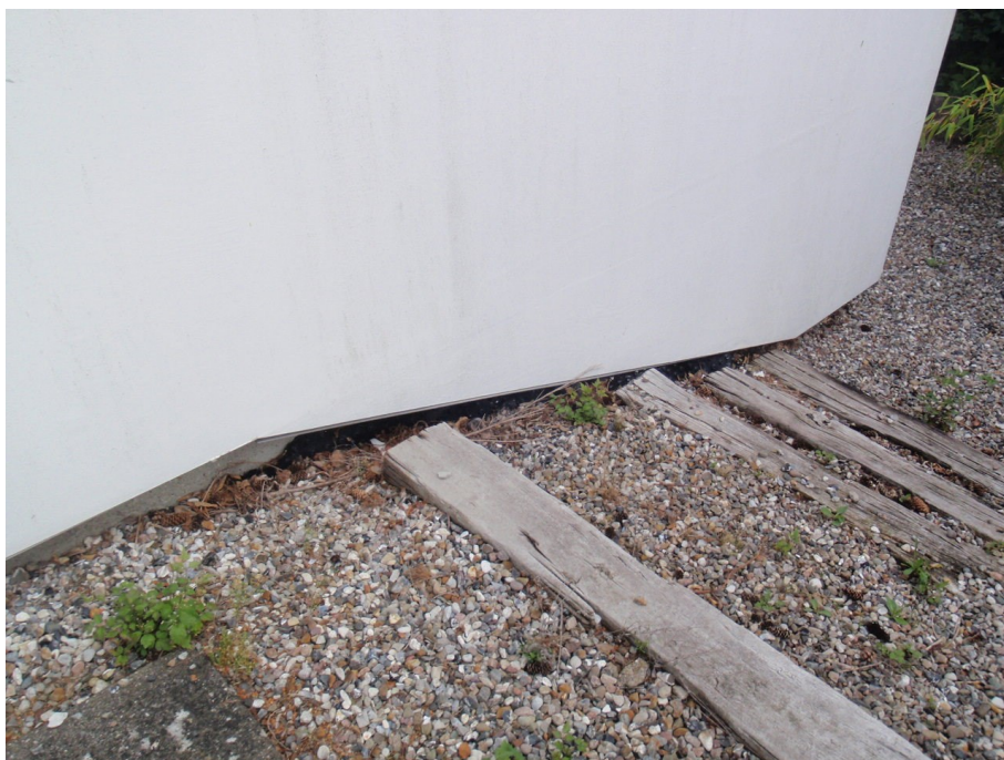
Foto 9 visende metalskinne under pladebeklædning – nederst – sydgavl
