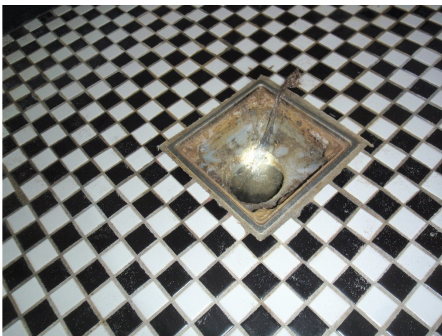
Foto 12 visende afskallet overfladebehandling i gulvafløb
