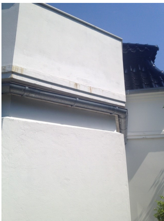
Foto 24 visende fugtaftegninger ved gesims/balkon
