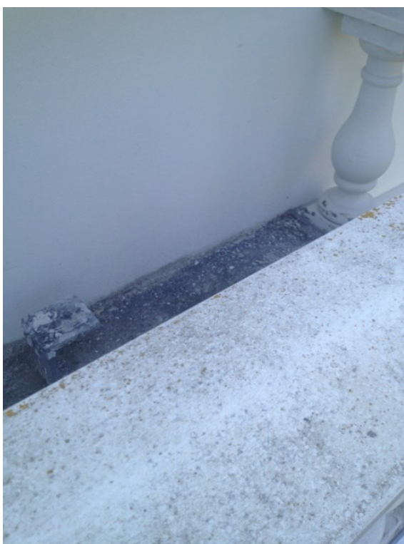
Foto 26 visende ikke korrekt inddækning mod hovedhus
