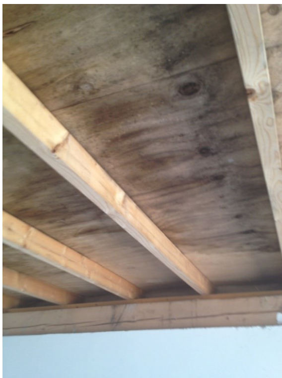
Foto 33 visende fugtskjolder på underside – krydsfinér
