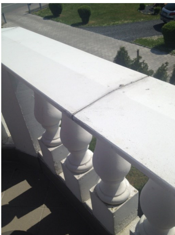
Foto 20 visende løs afdækningsplade – østkarnap
