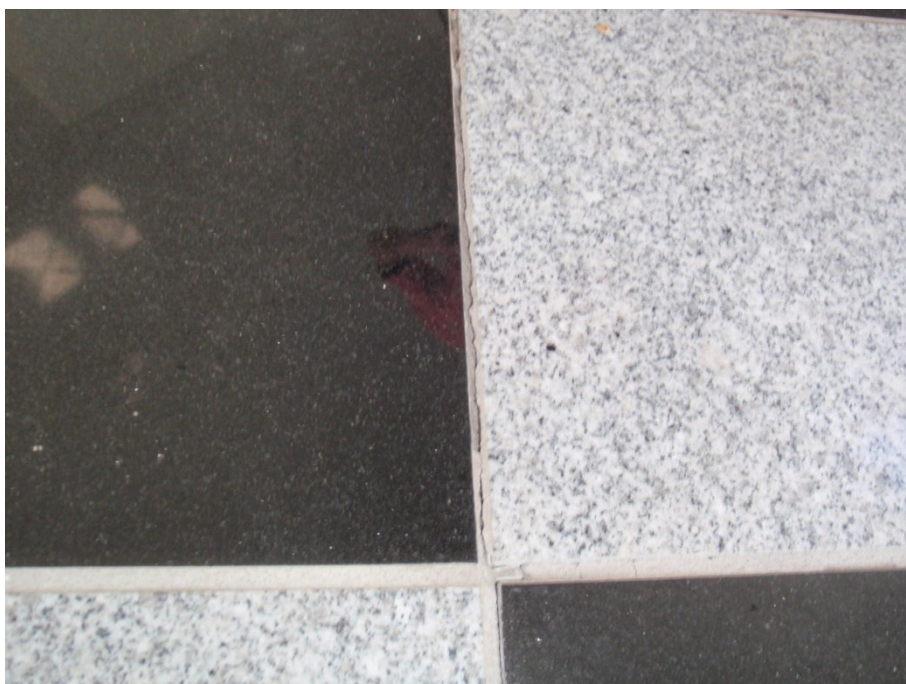
Foto 4 visende revnede fuger i klinkegulv
