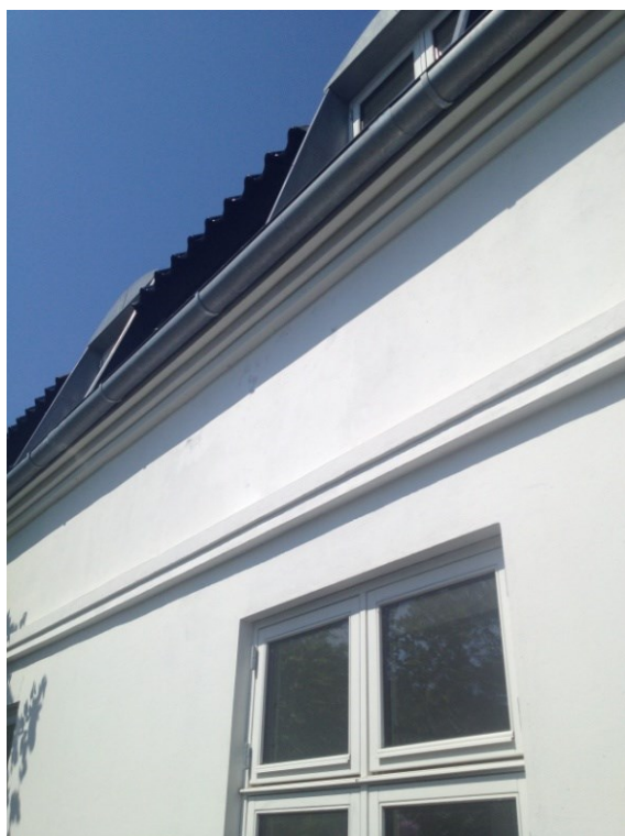
Foto 30 visende fugtaftegning under mansardvindue
