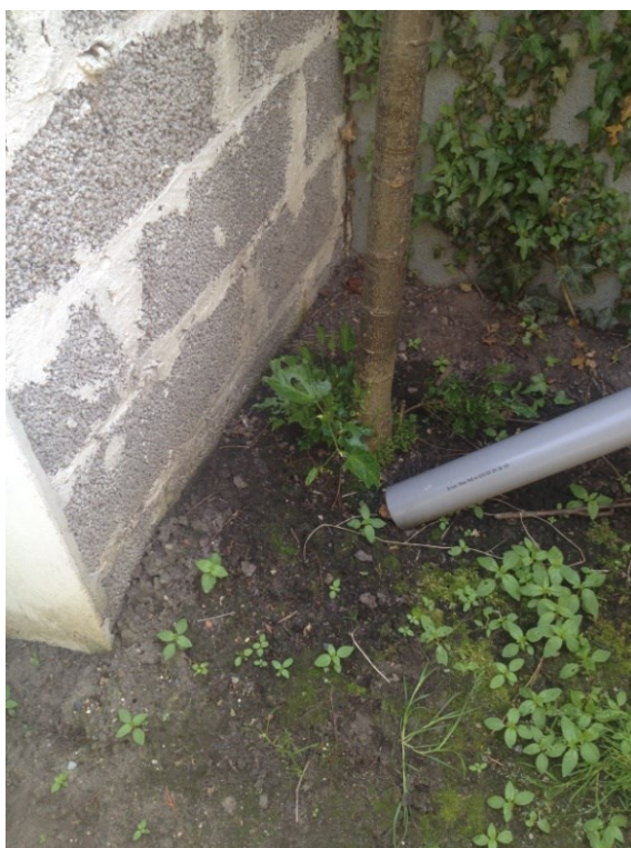
Foto 36 visende løst nedløb fra udhus
