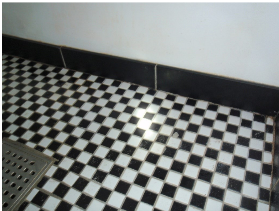
Foto 7 visende sokkelfliser – stuebadeværelser
