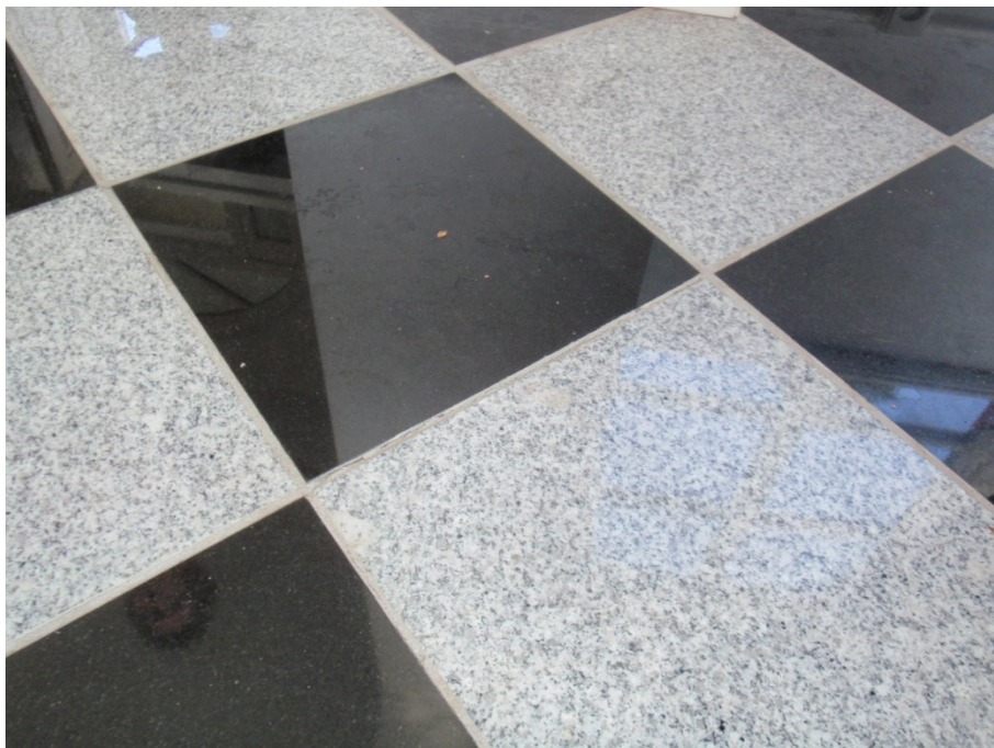
Foto 3 visende revnede fuger i klinkegulv
