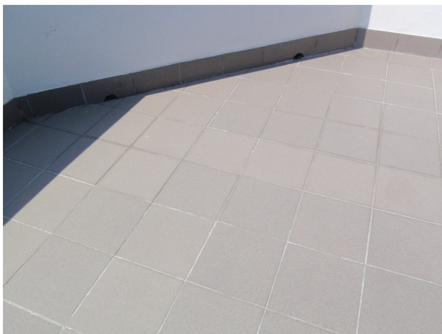
Foto 22 visende klinker på balkoner
