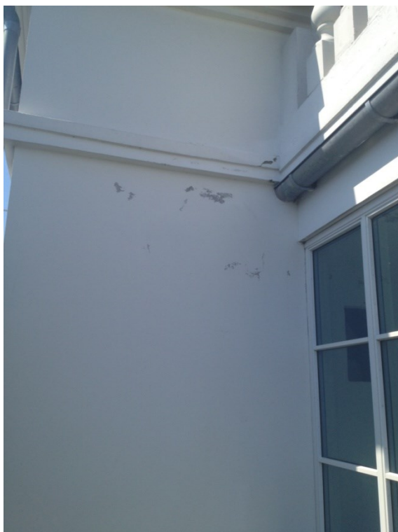
Foto 29 visende fugtskjolder/afskalning karnap øst
