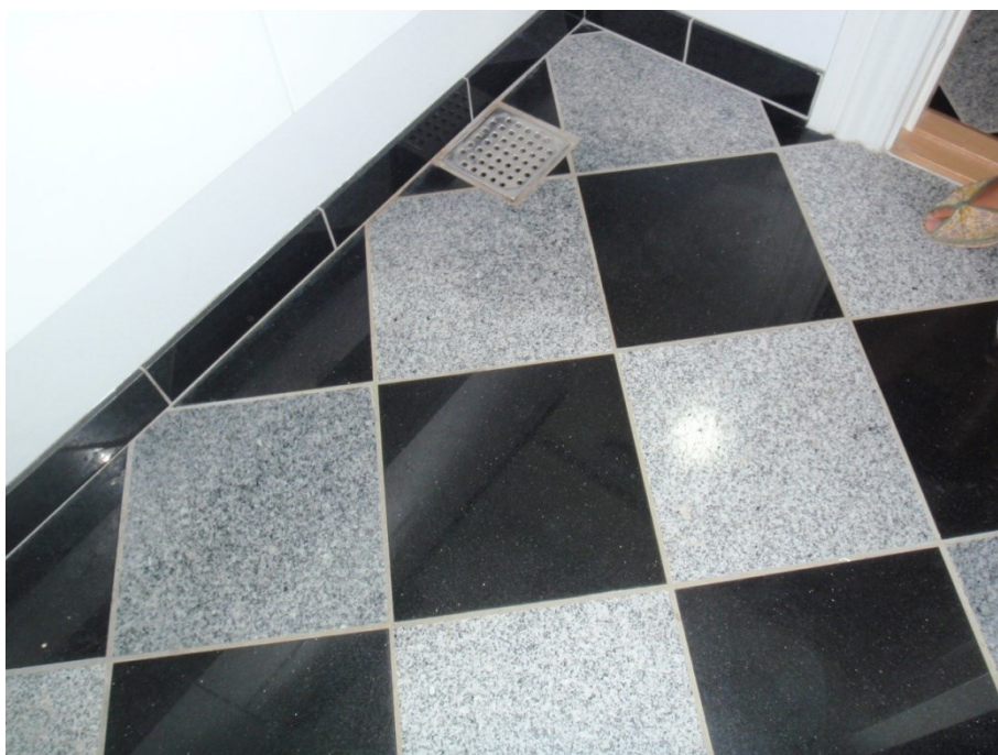
Foto 6 visende manglende niveauforskel < 30 mm fra overkant rist til vandfast dørtrin
