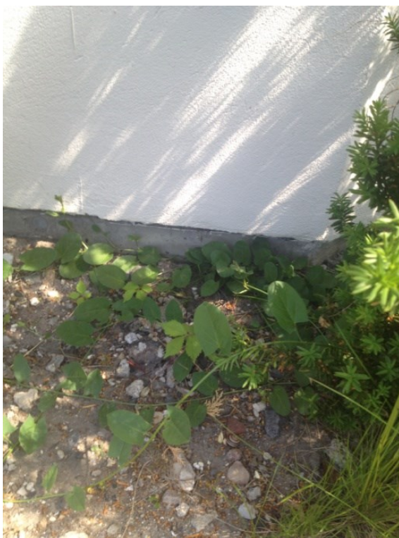
Foto 19 visende fugtspærre under puds
