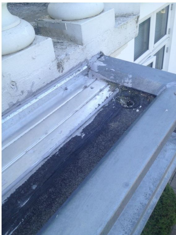
Foto 27 visende ikke korrekt interimistisk zink- og fugearbejde på halvtag
