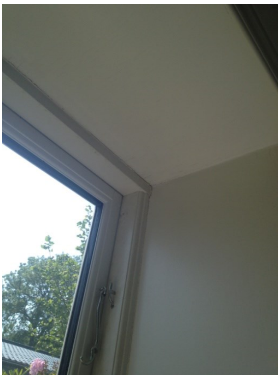
Foto 17 visende vandskjolder over vinduer
