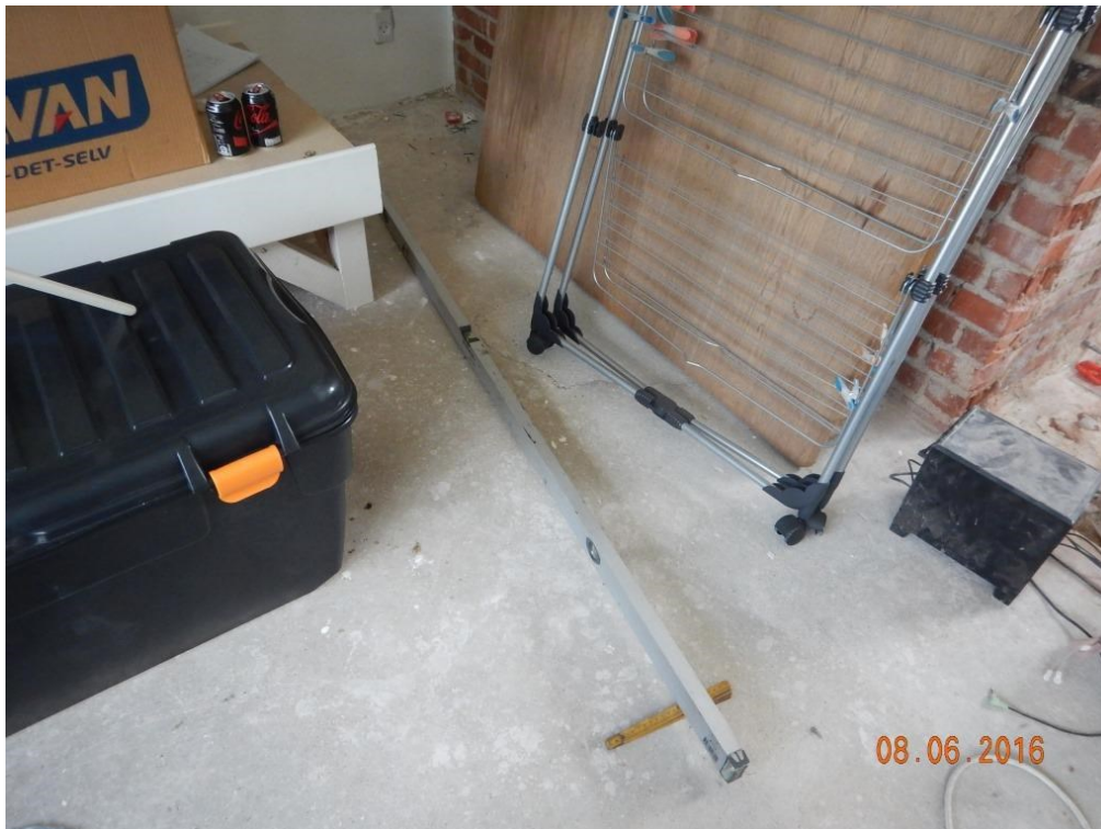
Betongulv i stuen, hvor der forekommer skævheder på op til 20 mm på en retskinne på 2 meter. Som retskinne ses på foto, ligger retskinne lige.
