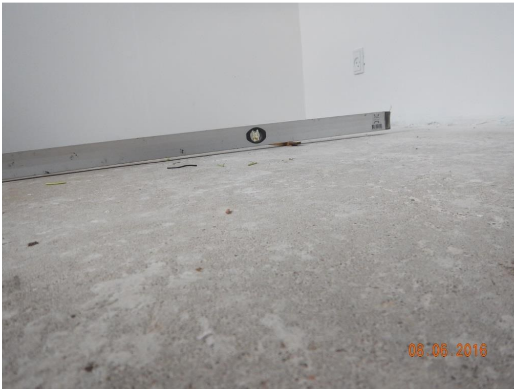
Betongulv i det store værelse, hvor der forekommer skævheder på op til 15 mm på en retskinne på 2 meter. Som retskinnen ses på foto ligger retskinnen lige.
