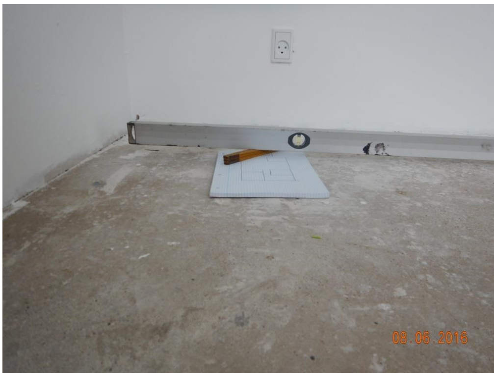
Betongulv i det lille værelse, hvor der forekommer skævheder på op til 30 mm på en retskinne på 2 meter. Som retskinnen ses på foto, ligger retskinnen lige.
