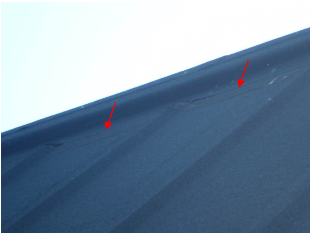
Foto 6 Øverst langs rygningen, ses der blotlagt underpap.
