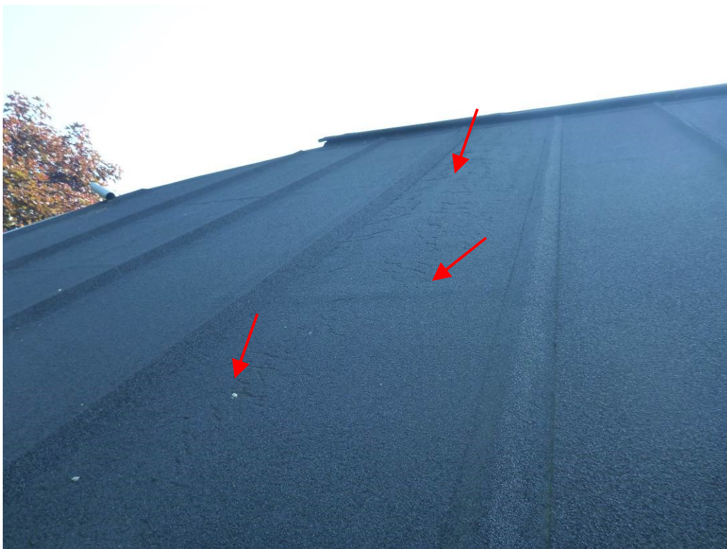
Foto 7 En enkelt bane har manglende skiferbestrøning / krakeleret bitumenlag.
