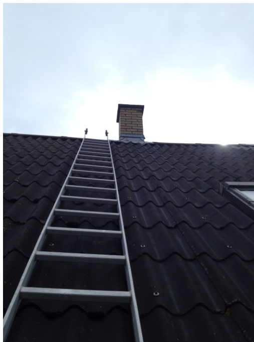
Billede 2 – Skorsten set fra vest – Manglende sten øverst
