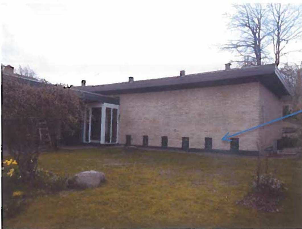
Foto nr. 1 Bygning A, set fra nord. De 6 kældervinduer (klagepunkt 2) ses th. for indgangen.
