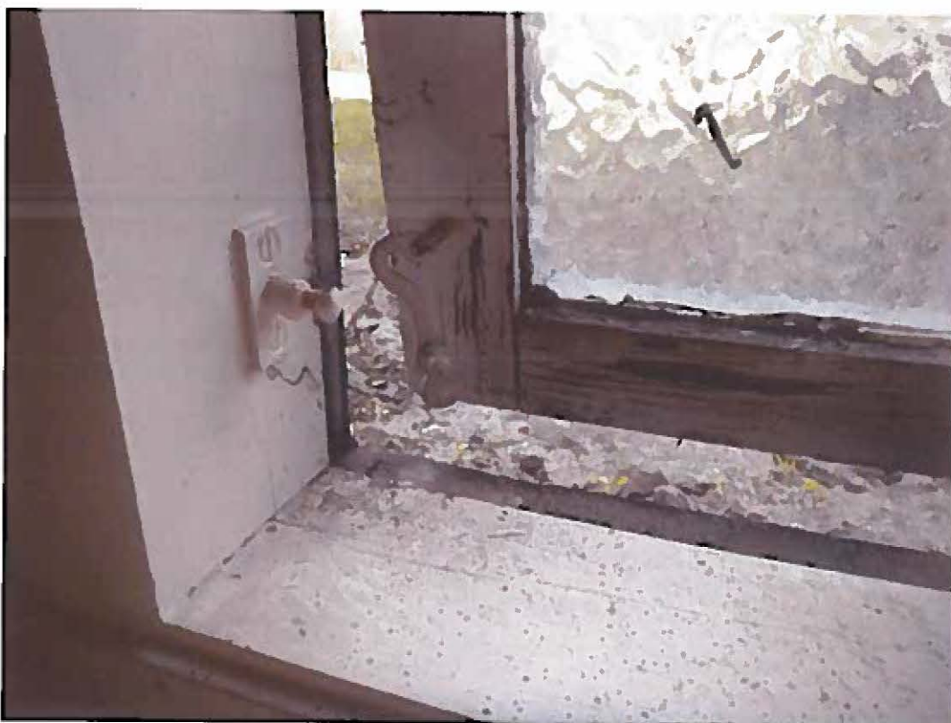
Foto nr. 5 Ældre trævinduer med enkeltlagsglas i kælderen. Afskalninger, ingen rådskader
