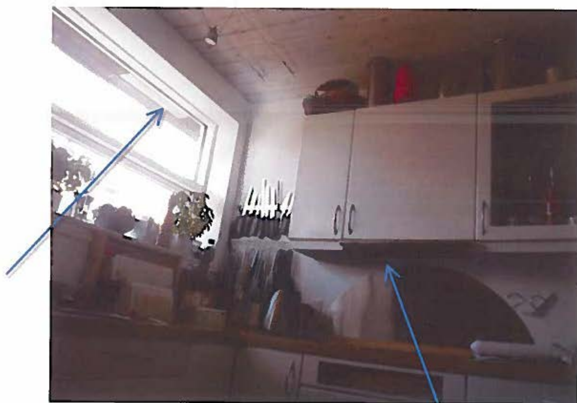
Foto nr. 9 Afkast fra emhætte har været ført ud i tagudhængen
