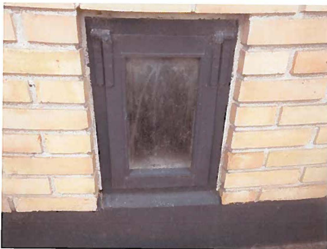
Foto nr. 6 Ældre trævinduer med enkeltlagsglas i kælderen. Afskalninger, ingen rådskader
