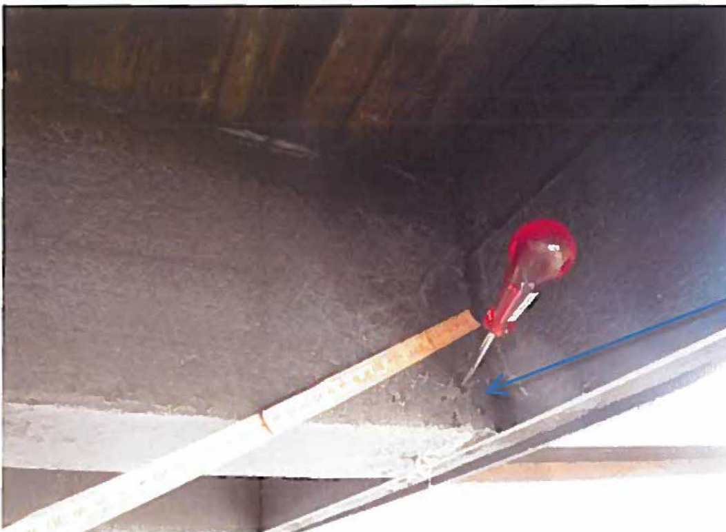
Foto nr. 8 Nedbrudt træ i to spærrender i carporten
