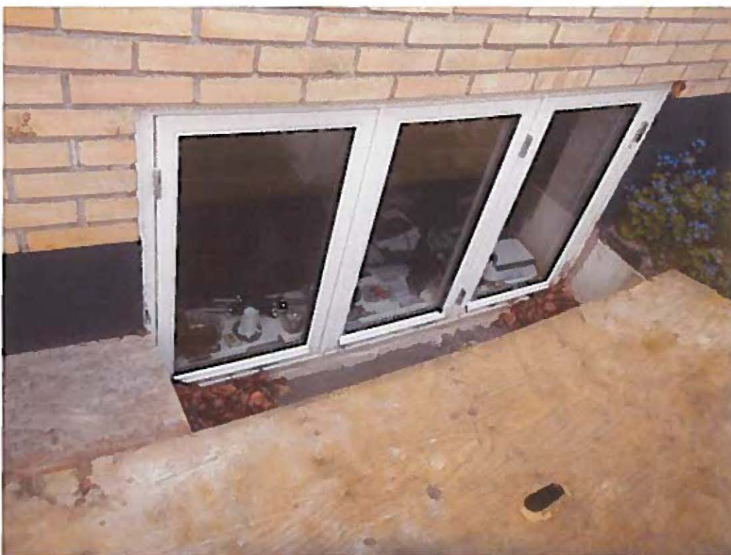
Foto nr. 12 Kældervinduet er placeret i en lyskasse og kan derfor ikke åbnes helt
