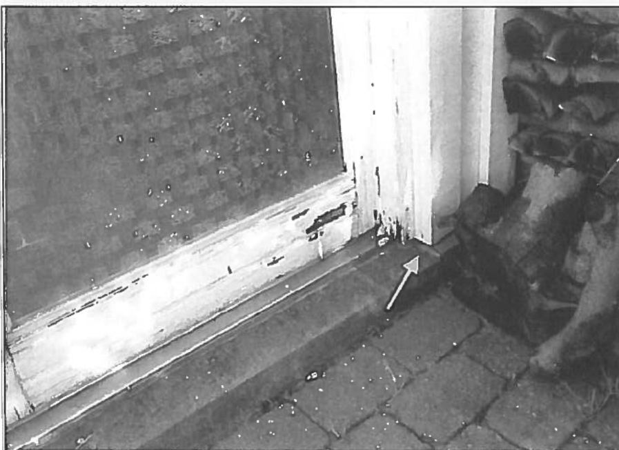
Foto nr. 28 Defekt inddækning i garage, indvendigt se foto 27
