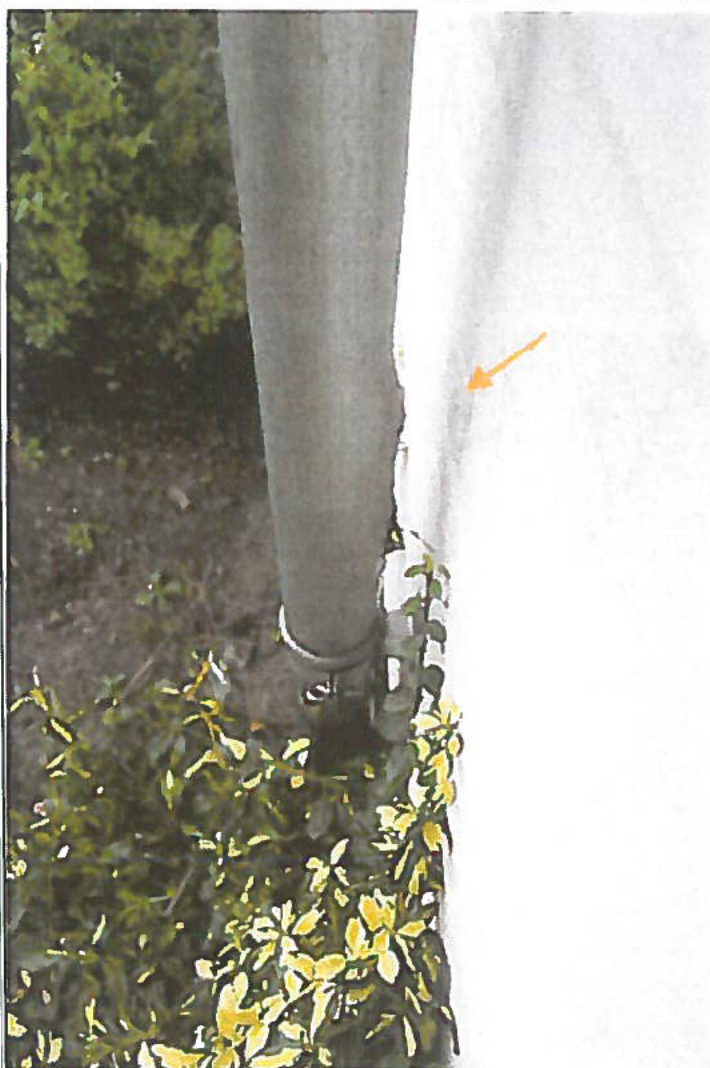
Foto nr. 18 Frostsprængt nedløb ved hushjørne mod SV
