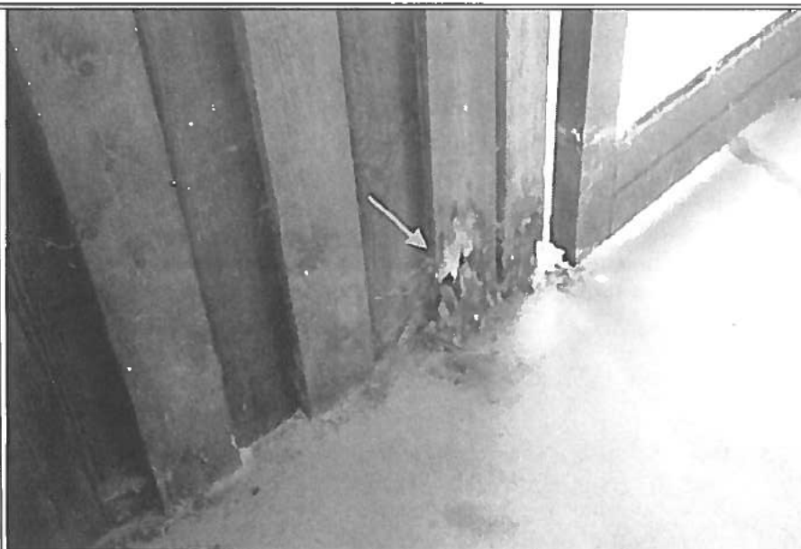
Foto nr. 27 Nedbrudt vægbeklædning i garage udvendigt se foto 28
