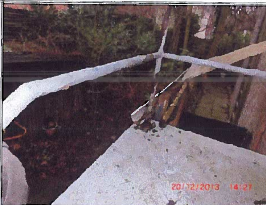
24 Tæret rækværk ved hovedtrappe.
