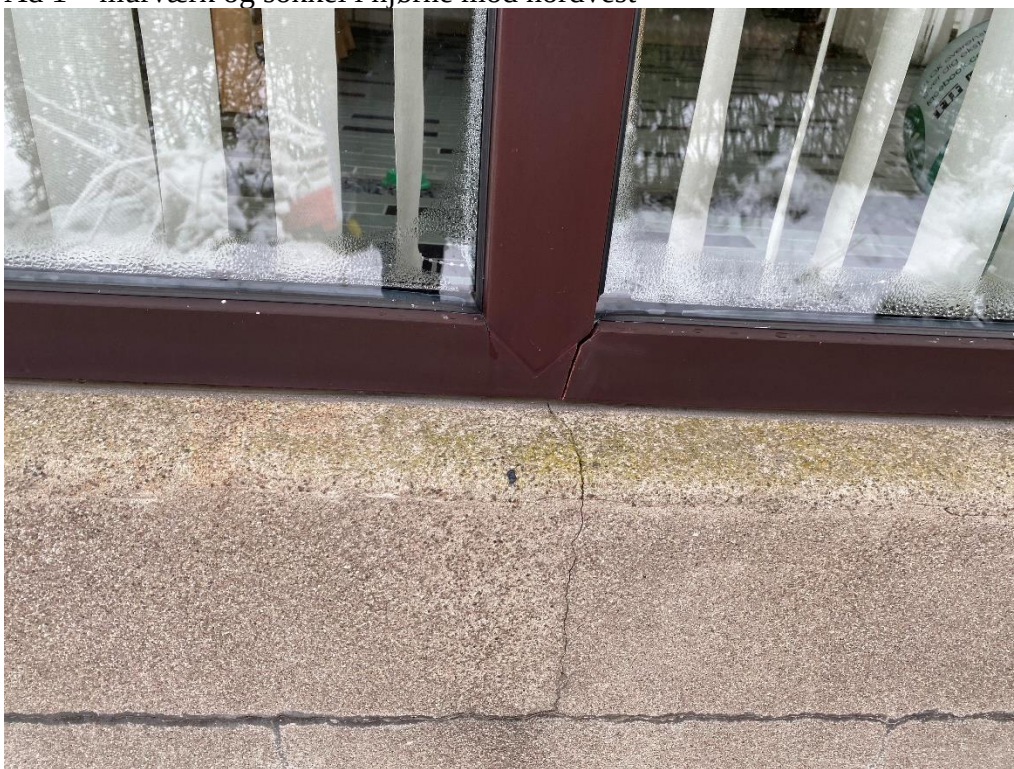
Ad 1 – revnet sokkel og vindueselement (et revnet vindueselement er yderst usædvanligt)
