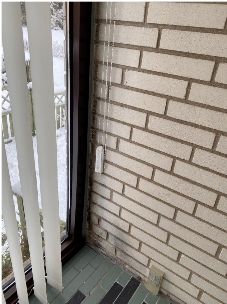
Ad 2 – mørkfarvning af murværk.
