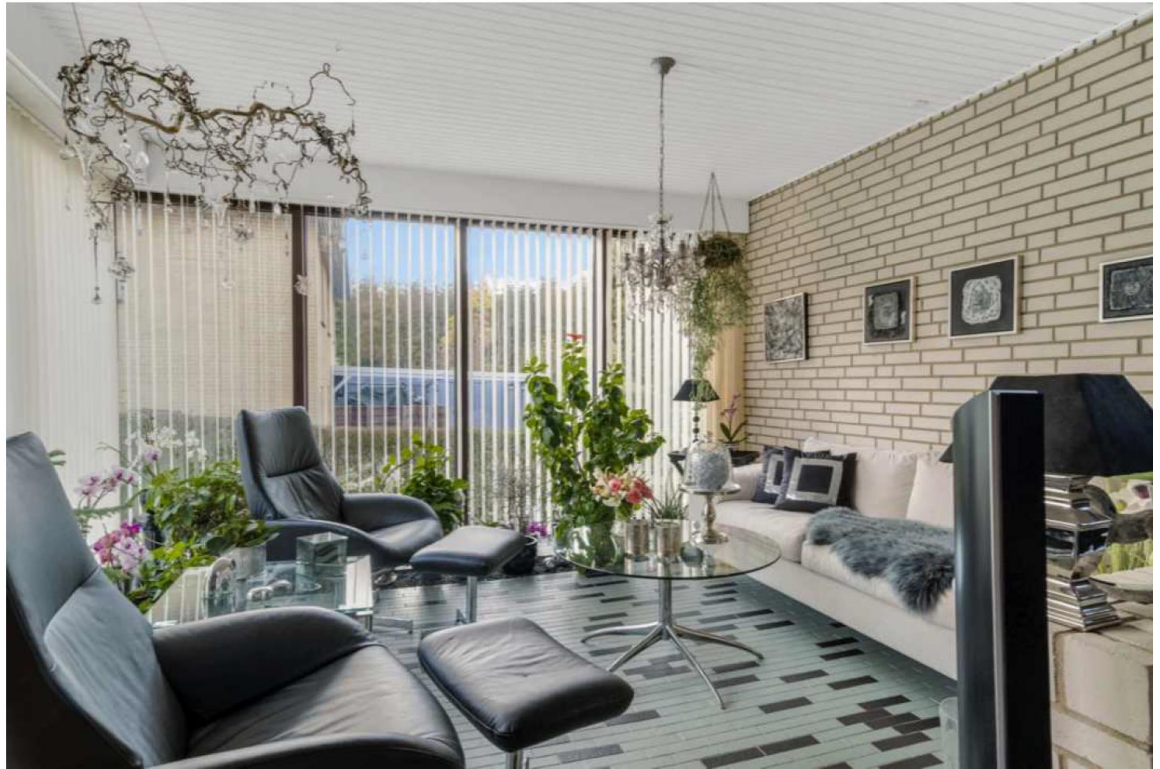
Ad 2 – Stue. Billede fra salgsoptstilling dateret 2/2/2023. Gardiner dækker for kuldebro/misfarvning
