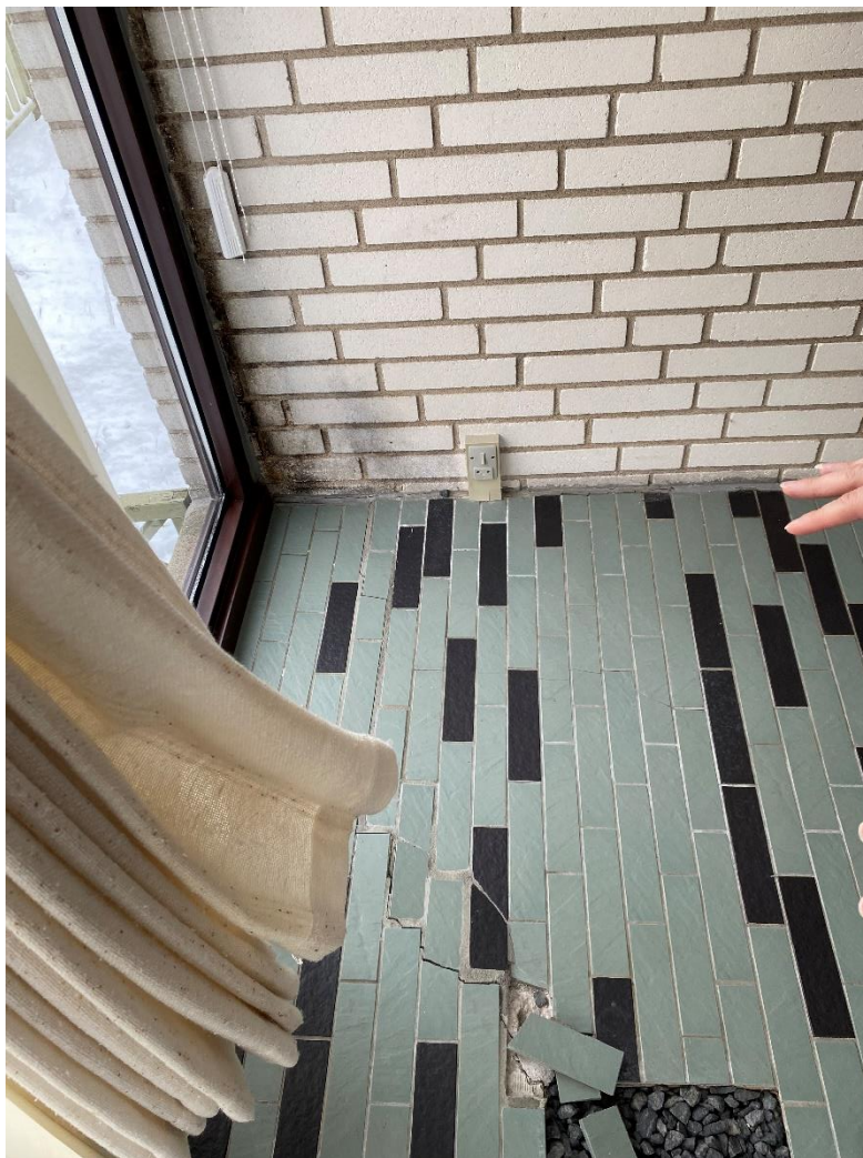
Ad 1 + 2. Gulv som er revnet og misfarvning i hjørne
