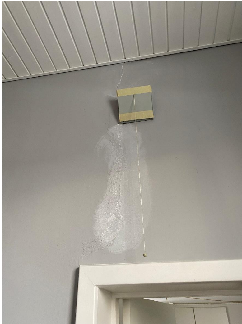
Ad 1 – revnet over dør i bryggers (skade 11 i TSR)
