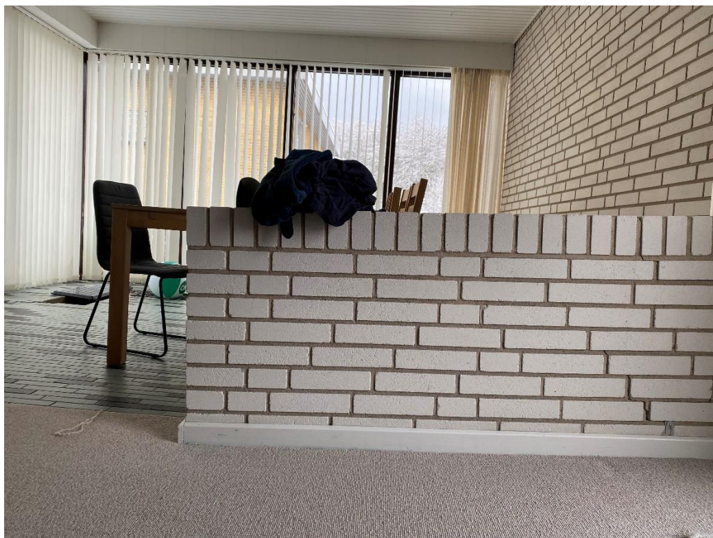
Ad 1 – halvmur og flisegulv hælder ind mod midten
