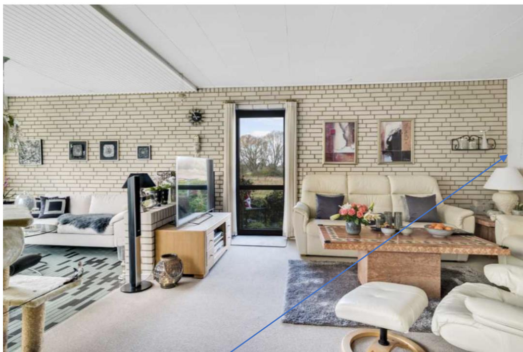
Ad 1 - Stue. Billede fra salgsopstilling dateret 2/2/2023. Synlig revnedannelse
