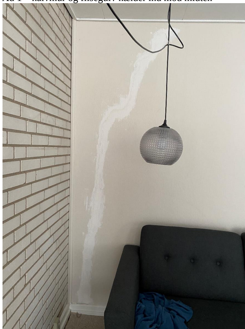
Ad 1 – udspartlet revne i væg i stue a (mellem stue og bryggers)
