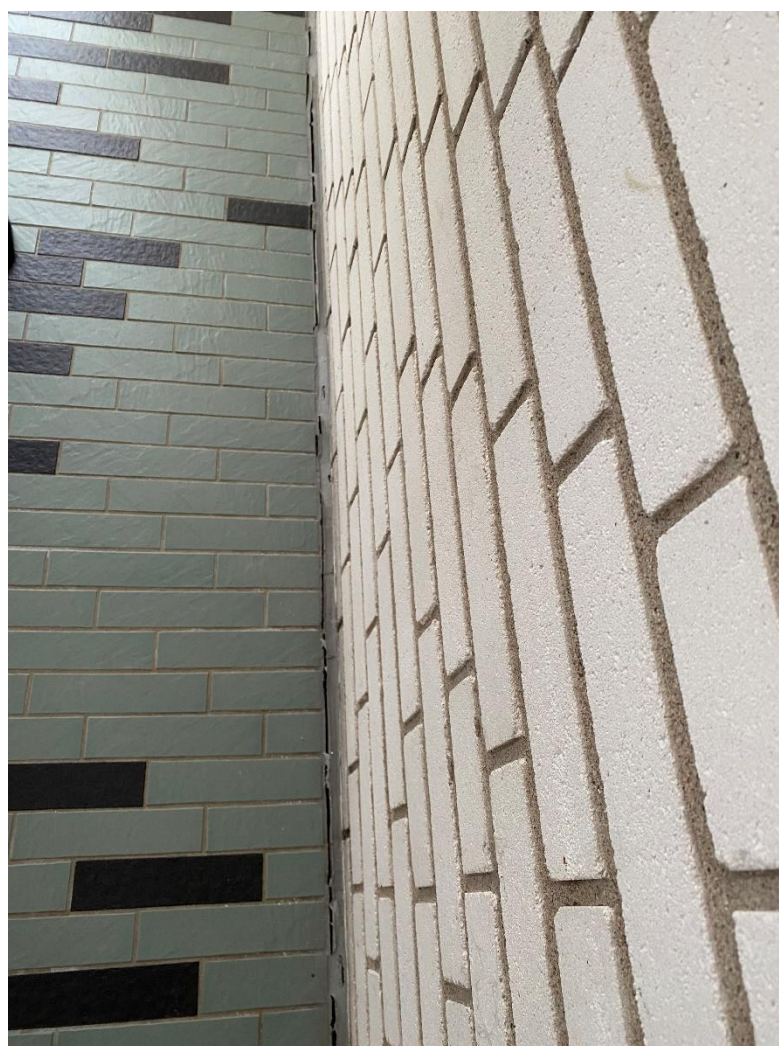
Ad 1 – Fuge mellem væg og gulv. Her var sofa placeret ved tilblivelse af TSR.
