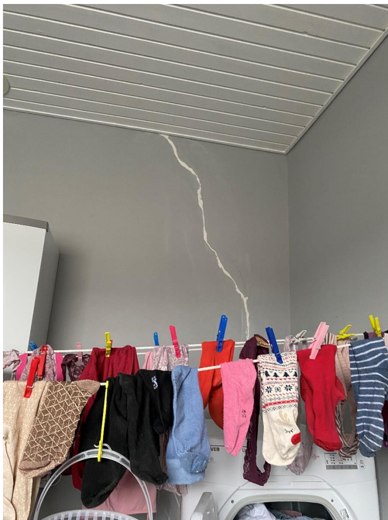
Ad 1 – revne i væg mellem bryggers og stue A
